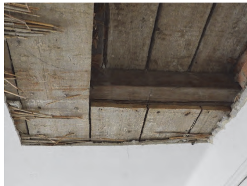
Figur 35. Taket har ett ytskikt bestående av puts på vassmatta. Bräder över bjälkarna har spår efter kransågning.
