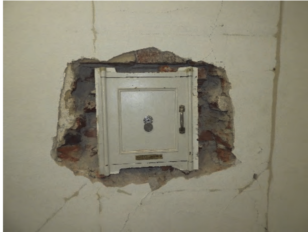
Figur 64. Kassaskåpets yttre dörr.
