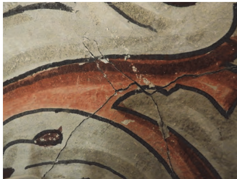
Figur 91. Exempel på sprickbildning som krävde infästning.
