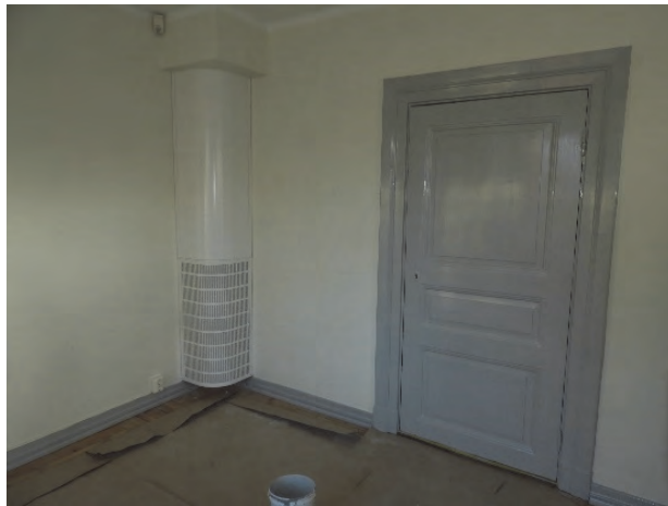
Figur 48. Nyttillkommen ventilationsutrustning i sydöstra hörnet.
