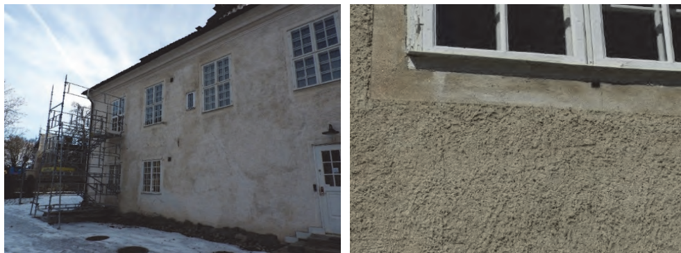
Figur 145. Norra fasaden har en ojämn avfärgning.
