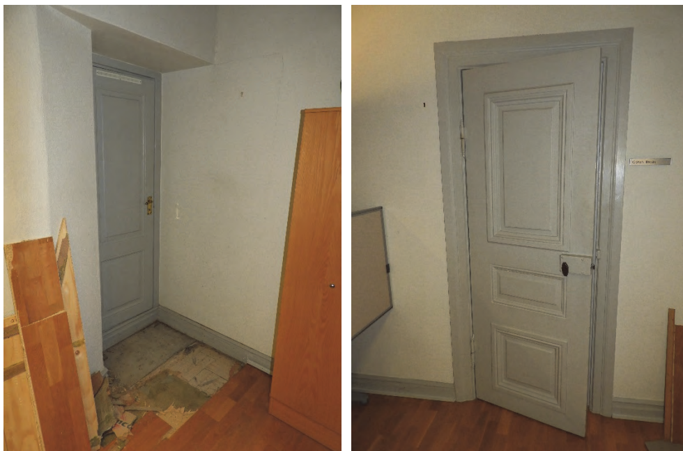
Figur 95. Modernt parkettgolv uppbrutet. Dörrbladet flyttat i samband med ombyggnaden till bottenplan rum 3106.
