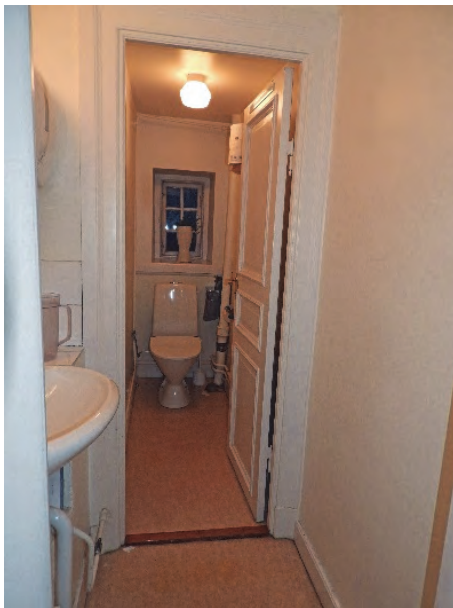
Figur 80. Toaletten före åtgärder.
