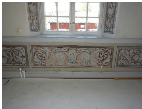
Figur 88. Befintliga radiatorer monterades bort. Bakom konstaterades att det fanns skador i måleriet.
