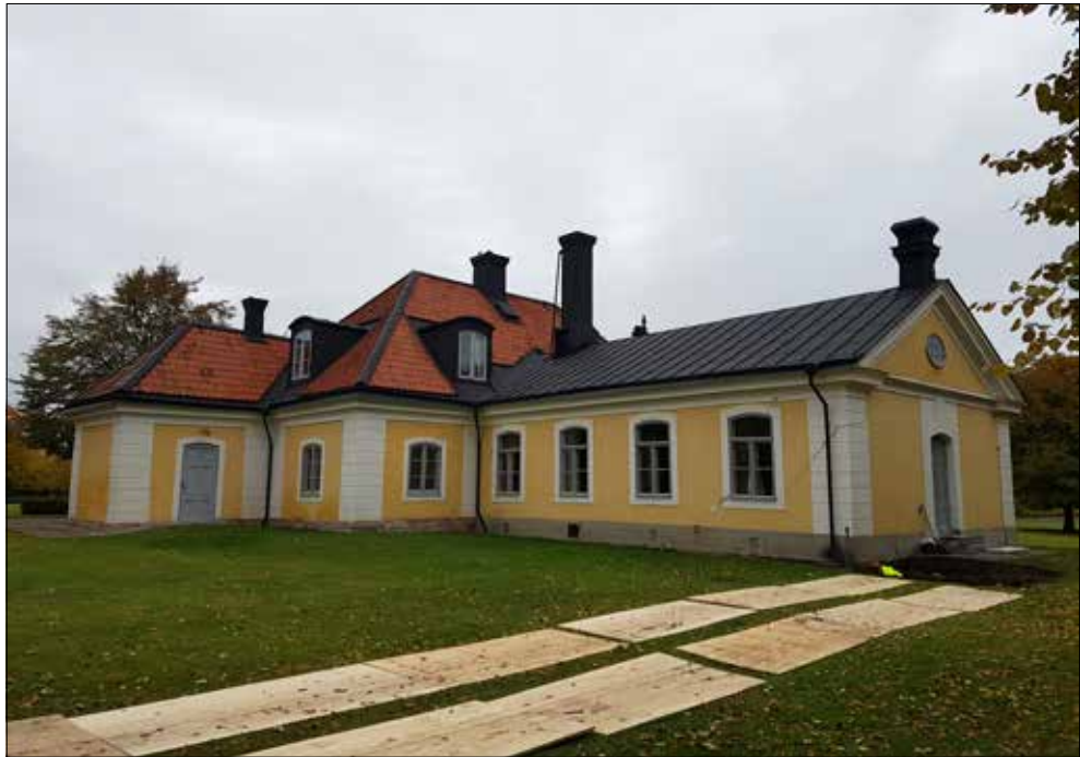
Figur 5. Stenbuset med den äldsta delen från 1700-talet till vänster. Till höger ses matsalsutbyggnaden med sprickan i väggen och schaktet utanför buset. Foto från sydväst.
