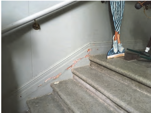
Figur 11. Golvlisten i trappan hade stora färgsläpp.
