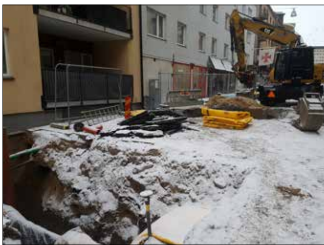
Figur 78. Schaktning i vinterförhållanden. I förgrunden syns schakt 7 och framför grävmaskinen schakt 10. Foto från väster av Duncan Alexander.
