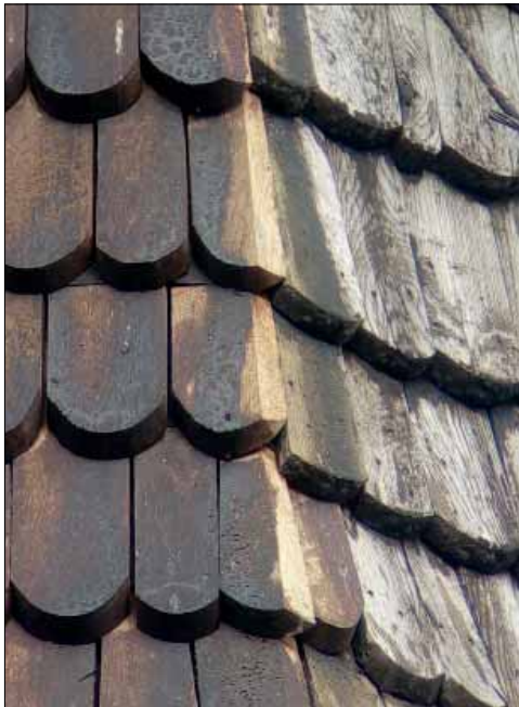
Ripsa kyrka. Västtornets spåntäckning med spån av två olika åldrar.
