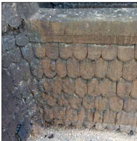
Almby klockstapel. Spånen på syllan har ett mycket tjockt och intakt tjärskikt.
