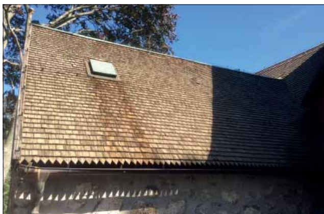
Kvistbro kyrka. Sakristians västra takfall. Uppsvängningen mot långhuset skymtar till höger i bild.
