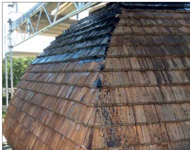
Blacksta klockstapel. Tjärning av huv pågår. Tjärblandningen är gjord utifrån ett recept från 1790-talet.
