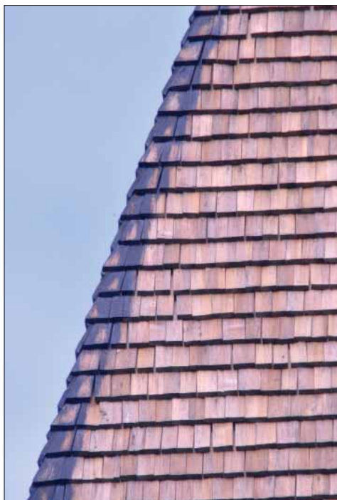
Hardemo kyrka. Vid inventeringstillfället i juni 2018 återfanns tjärrester endast vid takfallens brytningar, trots att spånen var nylagda och nytjärade.
