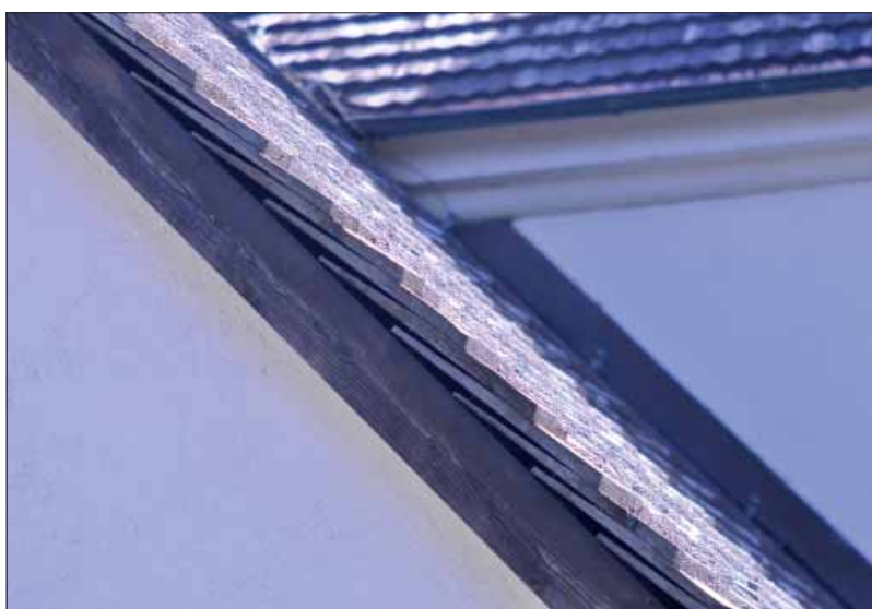
Hovsta kyrka. Sakristians spåntäckning slutar fritt i gavelutsprånget.
