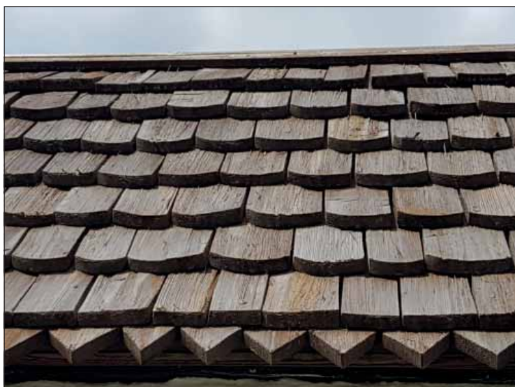
Åkers stigluckor. Spåntäckning på västra stigluckans tak.
