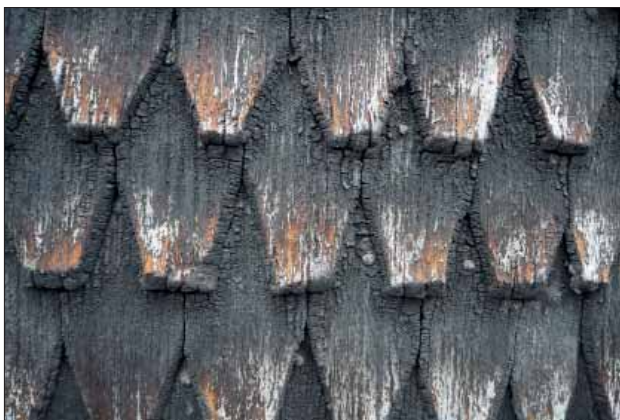
Figur 6. Tångerså kyrka, Strängnäs stift. Synliga asbestfibrer på södra långhusväggens spån. Foto Karin Myhrberg.
