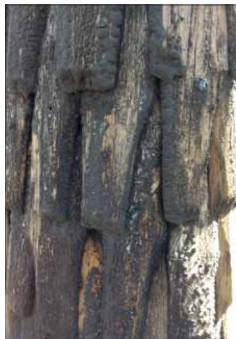
Blacksta klockstapel. Näbbformade spån på en av klockstapelns hjärtstockar. Spår av en grå beläggning syns på bilden, vilket kan vara spår av ett ytbehandlingsmedel som innehåller asbest.
