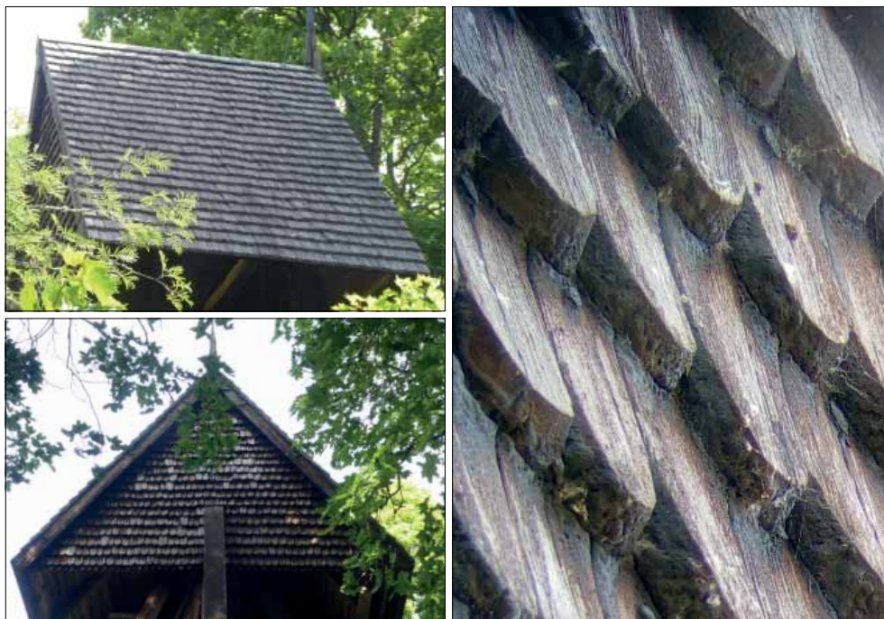
Nykyrka klockstapel. Fasadspån på klockstapelns huv. Vissa spån är utbytta och har synlig infästning.
