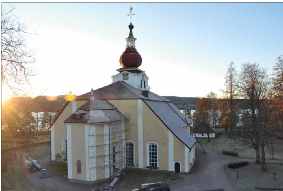
Figur 47. Leksands kyrka. På korets norra sida är en byggnadsställning rest. Bilden är tagen från klockstapeln 2018-11-22. Foto Lars Jönses.
