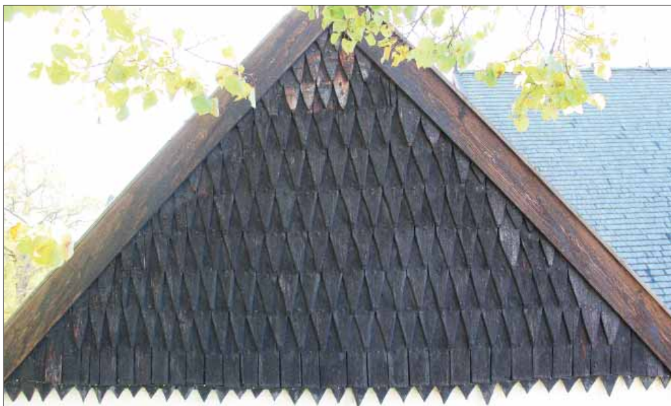
Figur 31. Tångeråsa kyrka, Strängnäs stift. Bild på sakristians gavelspets vars spån bedöms kunna vara från sakristians uppförande omkring 1450. Spånen är tillverkade med omsorg i jämn storlek vilket skapar symmetri i läggningen. Spånens spetsar är mycket noggrant gjorda med helt raka sidor utan antydning till svängar åt något håll. Att hugga alla spån till samma bredd innebär inte bara ett slöseri med material, det för även med sig en hel del merarbete. I praktiken innebär det att alla smala spånämnen som normalt hade använts sorteras bort. Likaså får de ämnen som skulle kunna ge breda spån huggas ner till en smalare form. Spåntäckningen berättar att ett viktigt mål i slutresultatet är att det rombiska mönstret ska följa rätta linjer. Foto Lisa Skanser.
