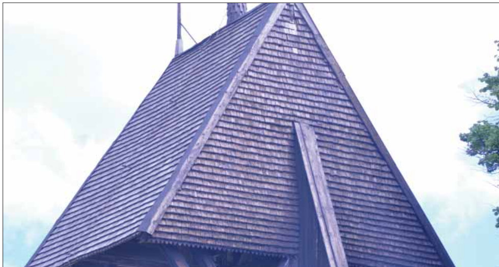
Tångeråsa klockstapel. Klockstapelns huv är i sin helhet spåntäckt. Fasaderna har gamla spån med tjocka tjärskikt med rester av rödtjära medan taket har en yngre spåntäckning.
