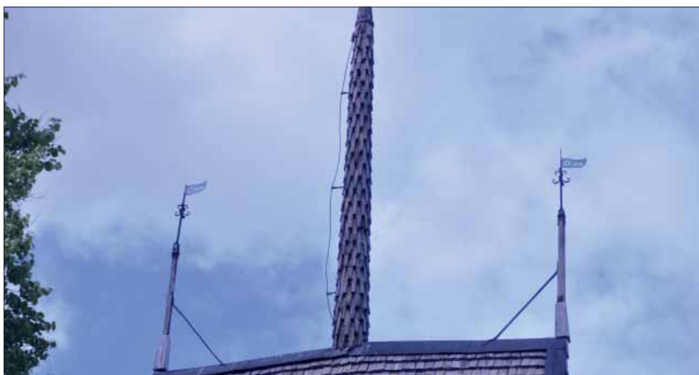
Tångeråsa klockstapel. Klockstapelns spira har nåbbformade spån som uppvisar rester av rödtjära.
