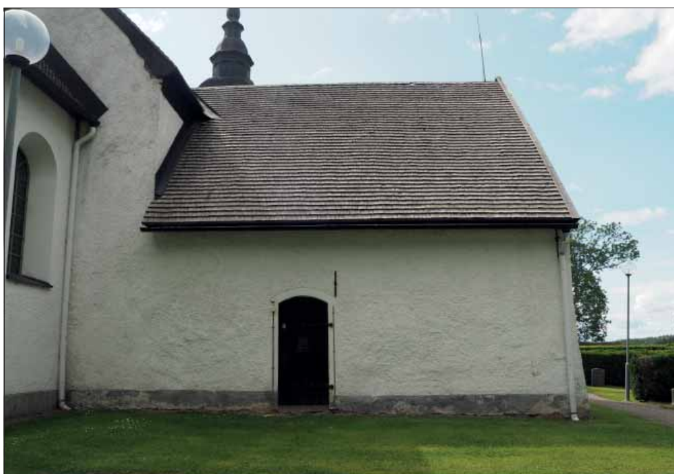
Vansö kyrka. Sakristians östra takfall.
