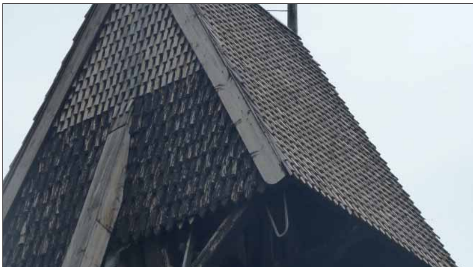
Helgesta klockstapel. På den ena gaveln finns äldre spån nedtill och nyare upptill.
