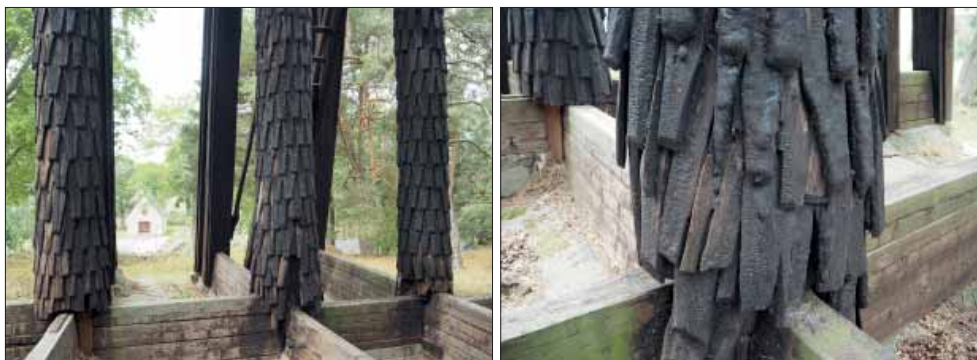
Björnlunda klockstapel. De tre hjärtstockarna täckta med näbbspån (t.v). Notera virrvarret av spån nertill på en av hjärtstockarna (t.h.).
