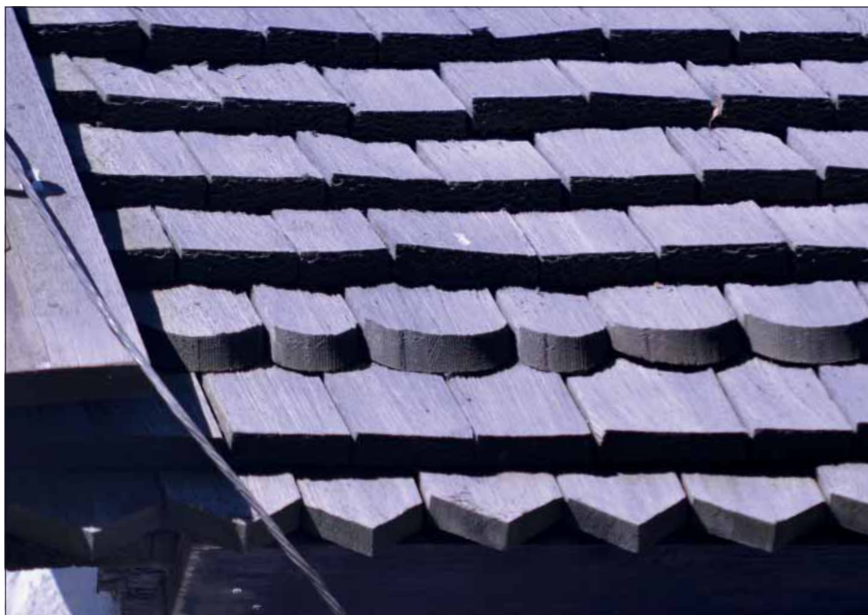
Hidinge gamla kyrka. Detalj av långhusets spåntak sedd från söder. Spånen har rak kant med mönsterläggning nedtill med spetsiga respektive runda spån på rad ett och tre.
