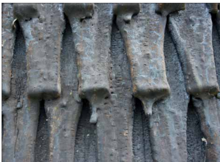
Figur 41. Kungs-Barkarö kyrka, Västerås stift. Spånen på tornets fasader täcks av ett tjockt pansarskikt, eventuellt så kallad rörtjära, eller så förekommer skikt av stenkolstjära. Foto Lisa Skanser.
