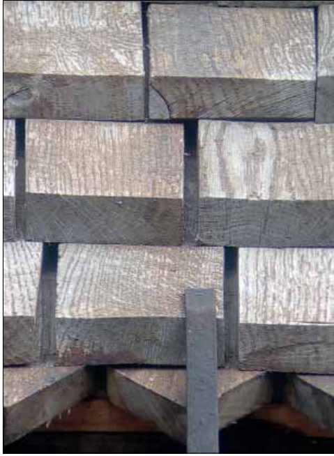
Ripsa kyrka. Spån på långhusets södra takfall.
