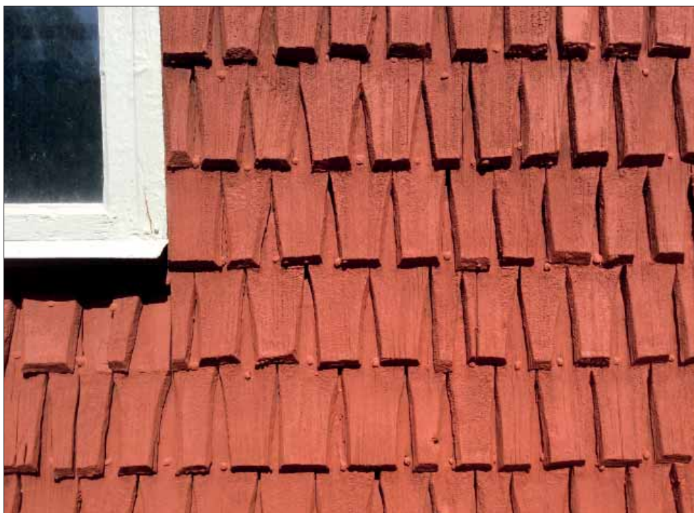
Skagershults gamla kyrka. Fasadspånen är av hög ålder och har synlig infästning.
