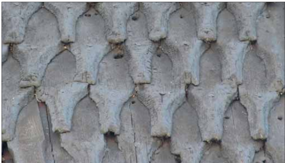
Figur 25. Spån på klockstapelns norra fasad vid Svedvi kyrka, Västerås stift. I höjd med ljudluckorna finns ett parti med spån som bedöms vara av mycket hög ålder. Spånens jämna bredder och symmetrin i läggningen påminner om spåntäckningen i Tångeråsa kyrka, Strängnäs stift, som förmodas vara från 1400-talet. På spånen syns hål från tidigare infästning ovanför befintlig infästning. Hålen är av större dimension än spikhål och i flera fall är de något förskjutna från spånets centrum vilket tillsammans talar för att spånen kan ha varit fästa med träplugg tidigare. Foto Lisa Skanser.
