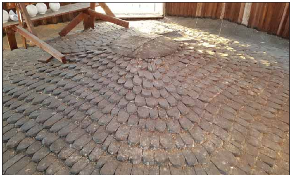
Figur 23. Hedemora kyrka, Västerås stift. Flackt spåntak med inskott av näver mellan spånskiften. Takytan är idag inbyggd och utgör golv i tornets lanternin. Spåntäckningen tillkom innan 1773 då lanterninen byggdes efter ritningar från 1750 av Carl Hårleman. Foto Lisa Skanser.
