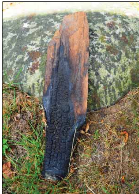
Sättersta klockstapel. Löst spån intill klockstapel. Spånet har synlig infästning och ett ganska tjockt, krackelerat tjärlager.
