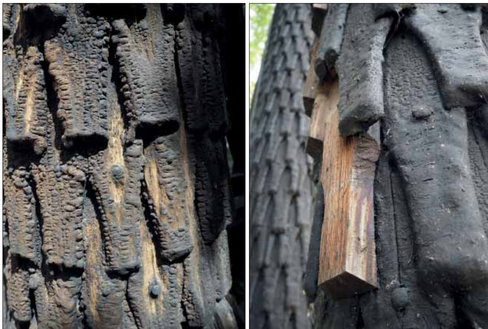
Lids klockstapel. Detaljer från hjärtstolpar. Synlig infästning och på vissa ställen ett tjockt lager tjära (t.v.). Äldre spån och ett fåtal nya spån (t.h.).
