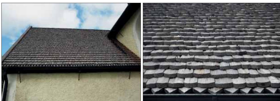
Härads kyrka. Kyrkan med spåntäckta tak sedd från nordväst (t.v.). Norra korsarmens östra takfall (t.h.).
