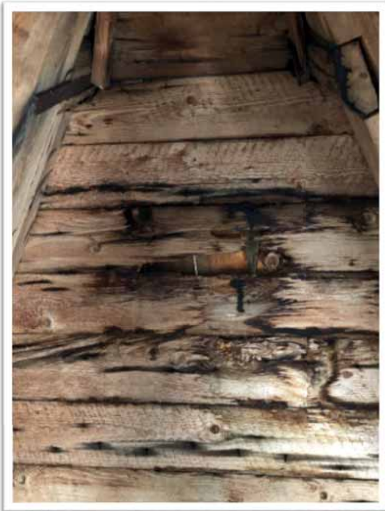
Rötskada i takhuvens undertak, norra sidan.
