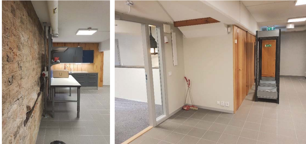
Figur 251. Inredningen är ställd en bit ut från väggen och har fästs i tak och golv.
