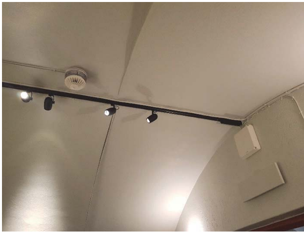
Figur 144. Spotlightskena och nytt ventilationsdon över dörröppning.
