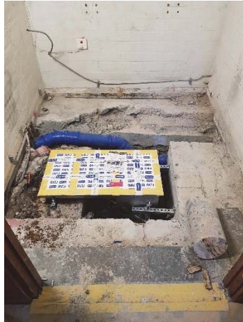
Figur 125. Ny golvbrunn I 132B
