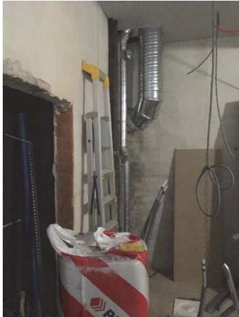
Figur 235. Ventilation i sydvästra hörnet.
