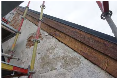
Figur 62. Nedknackad puts vid bomytar samt nya vindskivor.
