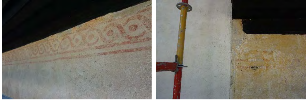
Figur 84. Dekorativ bård under takfot före åtgärder.
