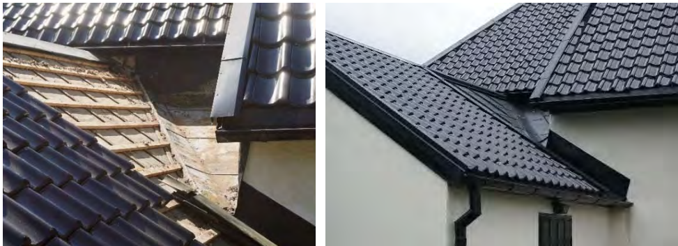
Figur 14. Bortriven ränna och delvis nedplockat tegel på sakristians västra takfall, mot långhuset.
