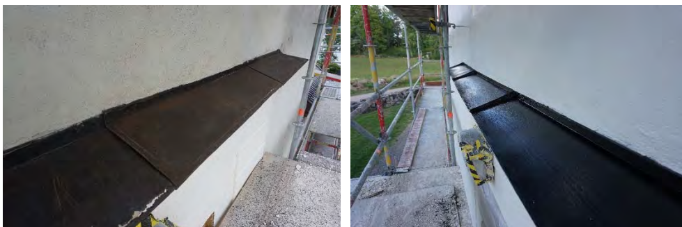
Figur 18. Plåtavtäckning över texttanla, västra entrén renskrapad. Det visade sig att skadorna var så omfattande att plåten måste bytas ut.
