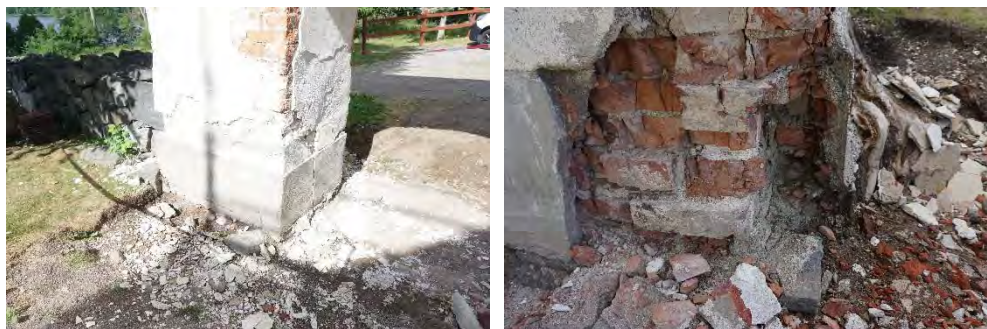
Figur 76. Stiglucka med nedknackad puts.
