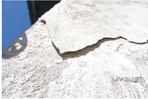
Figur 58. Spjällning av yttre puts-skiktet före åtgärder.
