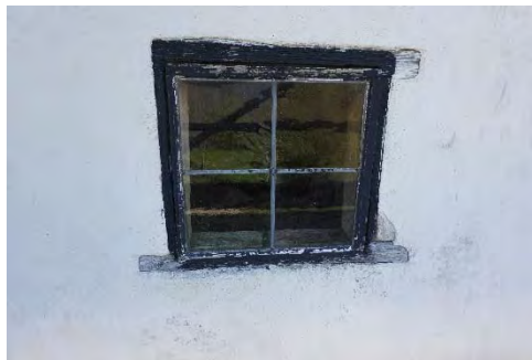
Figur 36. Fönster på västra gavelröset före åtgärder.
