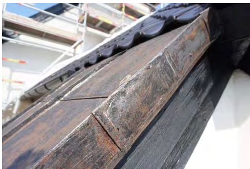
Figur 28. Renskrapad plåt på kontrefort.
