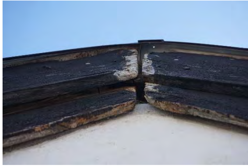
Figur 20. Vindskivor västra gaveln före åtgärder.
