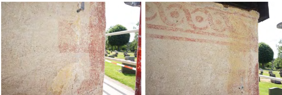
Figur 82. Målad hörnkedja före åtgärder.
