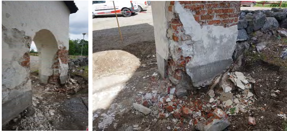
Figur 74r. Stiglucka med nedknackad puts.
