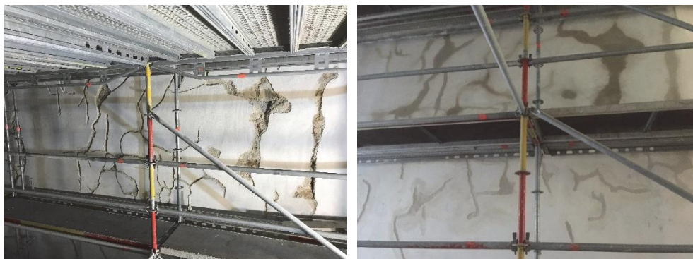
Figur 19. Exempel på upphuggna sprickor. Norra korsarmen östra väggen. Foto: Göran Berglund. Figur 20. Putslagning, norra korsarmen östra väggen.
