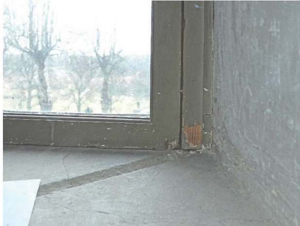
Figur 53. Innerfönster södra sidan före åtgärder.
