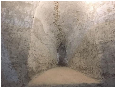
Figur 25. Puts i absidfönster med missfärgningar.
