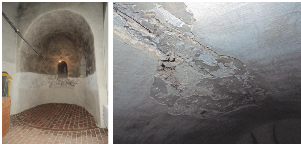
Figur 17. Nedre delen av väggarna hade rengjorts redan i tidigare etapp. Figur 18. Tunnavlv över korets västra del. Äldre putslager med grå avfärgning.
