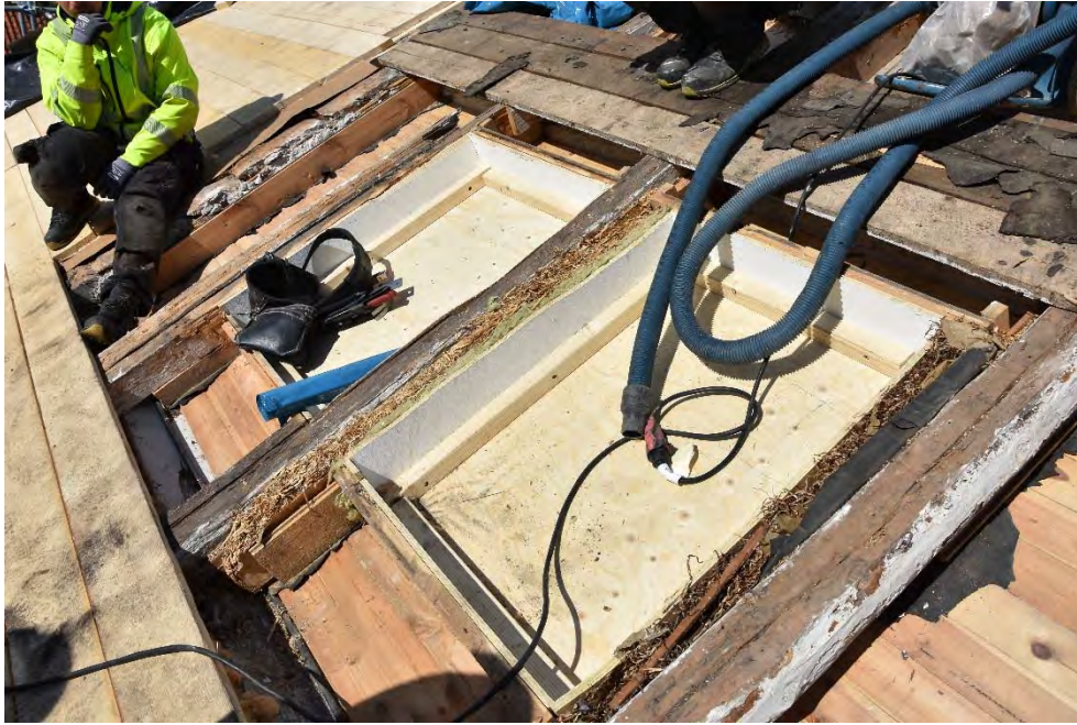
Figur 29. Takfönster sattes igen på grund av rötskador i omkringliggande konstruktion.
