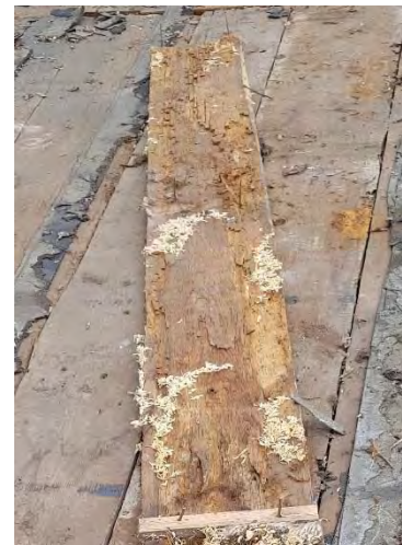
Figur 18. Kraftigt insektsangripen undersida av bräda från undertaket. Foto: Stefan Ilhammar.
