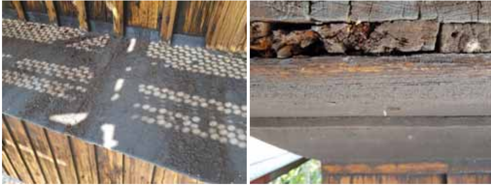
Figur 39. Tjärad plättäckning på gesims före åtgärder.
