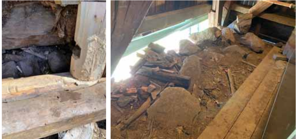
Figur 63. Timmerlagning i nedre del av stolpe på södra sidan, östra delen. Foto: Lars Pernhall. Figur 64. Stenpackning södra sidan togs delvis bort tillfälligt. Foto: Lars Pernhall.
