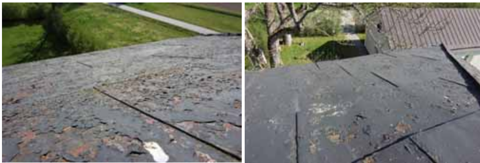
Figur 10. Omfattande rostangrepp, flagnande färg.
