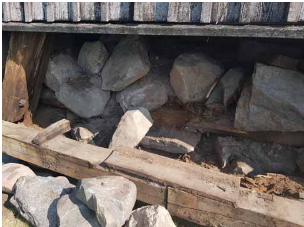
Figur 29. Rötskador på inre syll.
