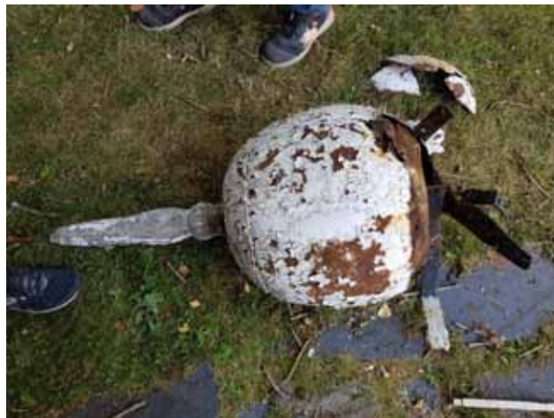
Figur 42. Kraftigt rostangripen plåt. Delar av de undre plåtarna har lossnat.
