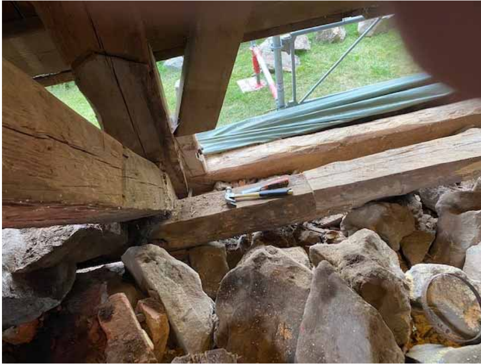
Figur 66. Utbytta syllar södra sidan, skarv i den östra delen. Foto: Lars Pernhall.
