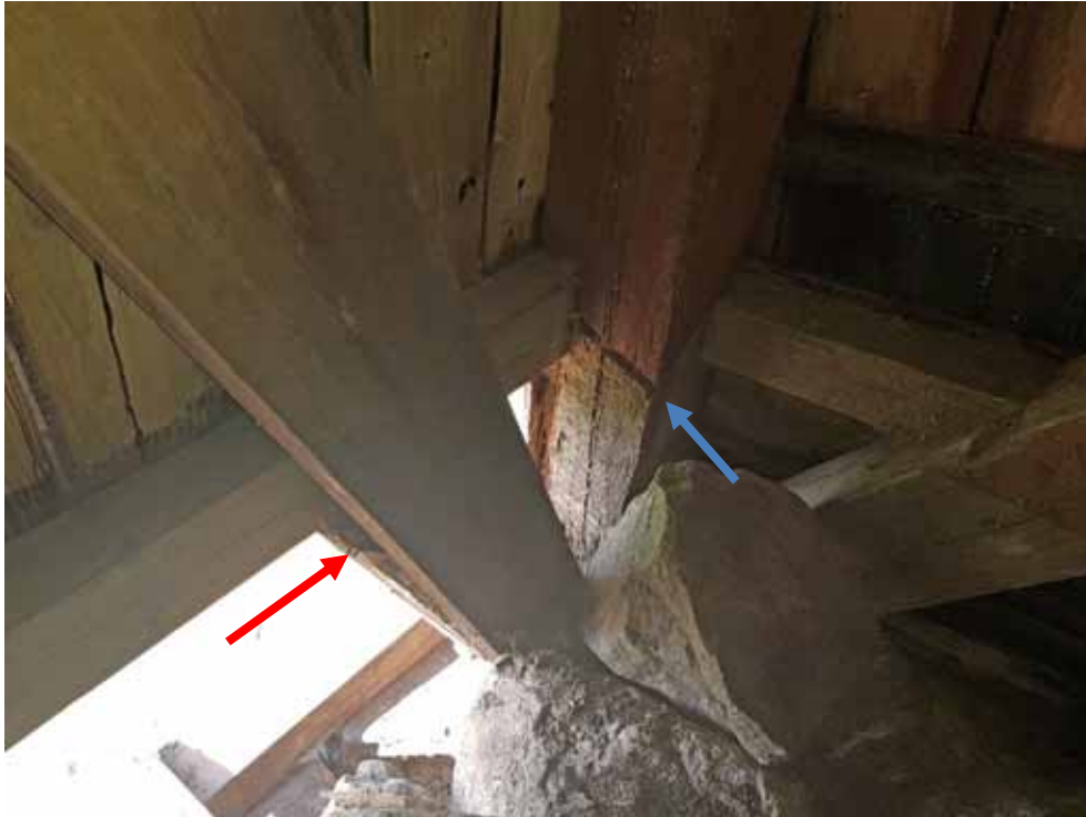
Figur 26. Sydvästra hörnet sett inifrån snedsträvan till vänster är ny. Vid den röda pilen anas resterna av den gamla snedsträvan som syns på figur 24 och 25. Vid den blå pilen syns inhuggna spår i hörnstolpen. Spår efter tidigare konstruktion som återfinns även på andra stolpar.
