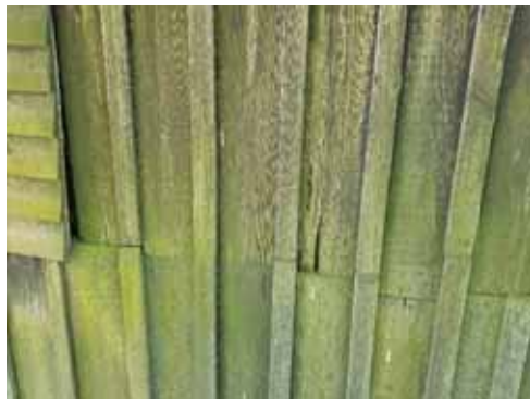
Figur 35. Rötskadad bräda norra sidan
