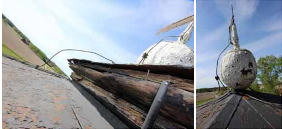
Figur 14. Kraftigt rötskadat virke i profilerat listverk till vänster och klot och spira till höger. Spikar i plåten tycks ha lossnat från underlaget.
