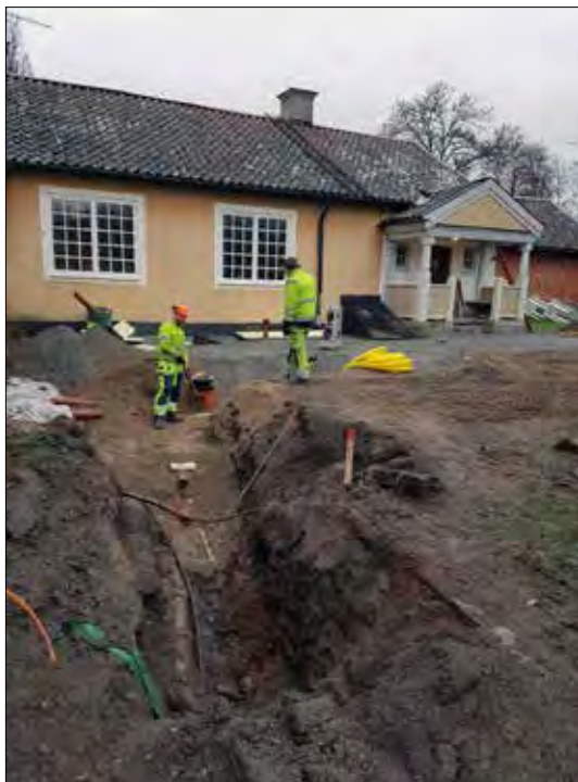
Figur 20. Översikt som visar västra delen av schakt 5. Den nya spilledningen lades ner bredvid de befintliga ledningarna. I bakgrunden ses Komministergårdens mangårdsbyggnad. Foto från öster.
