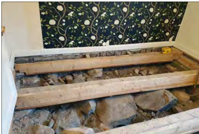
Figur 36. En syllstensrad framkom under golvet i Komministergården (figur 35 och 37). Syllstenarna, A10, var lämningar från en byggnad som brann 1714. De liggande bjälkarna är underlag till det befintliga golvet. Foto från nordöst.
