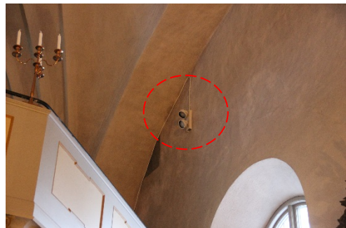
Figur 28. Ny dubbel spotlight vid läktare. Kabel klamrad utefter valvet och rakt ned till spotlight.
