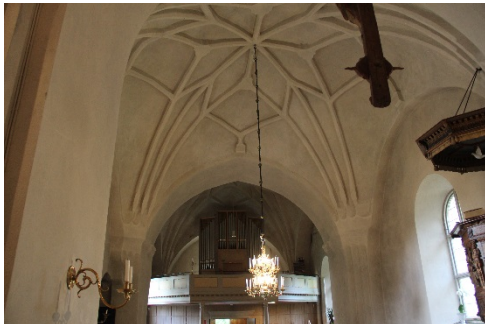
Figur 19. Östra långhusvalvet före åtgärder.
