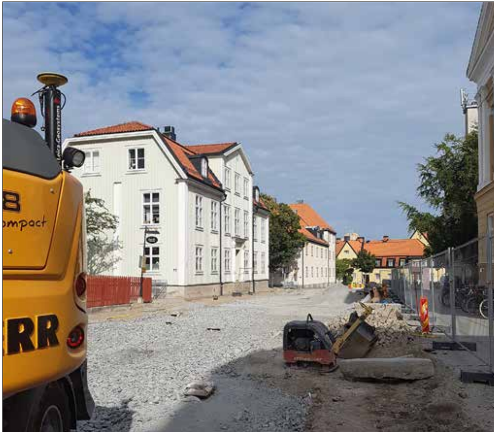
Figur 59. Skolgatan vid delområde D. Bakom grävmaskinen till vänster i bild ligger Rektorsgatan. I gatan framför det röda staketet ligger lämningarna efter hus 7 och 8. Till höger skimtar gamla annexet. Fotograferat av Oskar Spjuth från sydväst.
