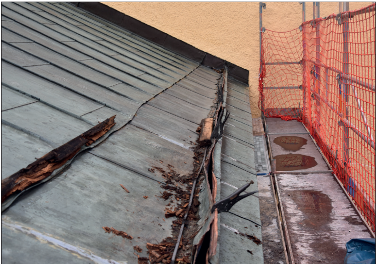
Figur 9. Här ses murkena brädor som påträffades vid öppning. Två brädor har bytts ut.
