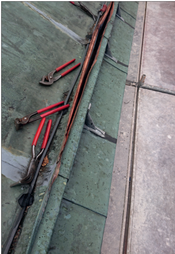
Figur 16. Vid öppning påträffades rötskadad bräda.
