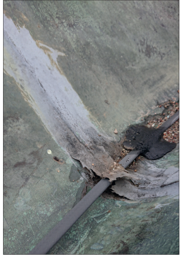
Figur 15. Detalj av dåligt utförda lagningar med någon typ av spackel.
