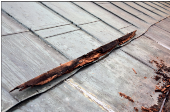
Figur 11. Detalj av rötskadad bräda.
