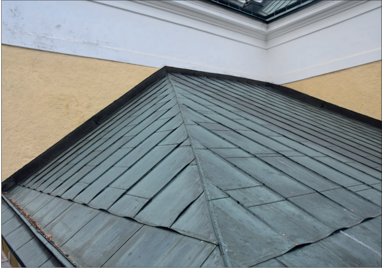
Figur 22. Utblick över taket vid slutbesiktning i oktober 2021. Plåten sluter nu bättre mot fasaden och öppna falsar har tillslutits.
