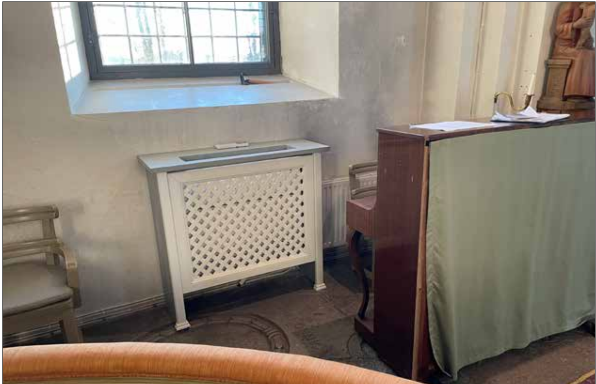
Figur 23. Luftvärmepumpen på den södra sidan.
