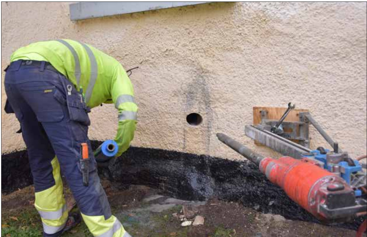
Figur 9. Hålet sett från utsidan.
