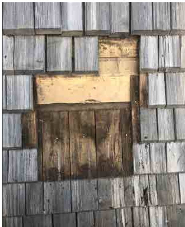
Figur 3.224. Spånyta efter demontering. Sentida underlagstak i takfot. Foto Daniel Eriksson.
