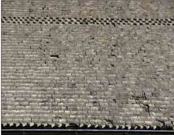
Figur 3.220. Del av långhusets södra takfall före demontering. På takfallet fanns rötskadade spån och flera spån saknades. Foto Jennie Björklund.
