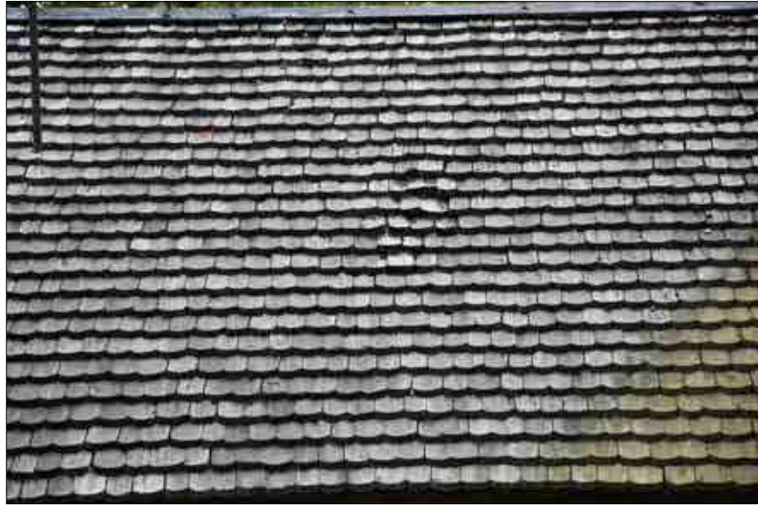
Figur 3.296. Sakristians västra takfall efter återmontering av ersättningspån som tjärats. Foto Jennie Björklund.
