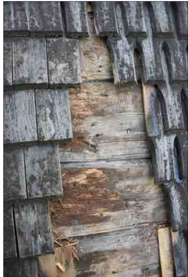
Figur 3.266. Närbild av undertak efter demontering, här syns fuktskador. Foto Jennie Björklund.
