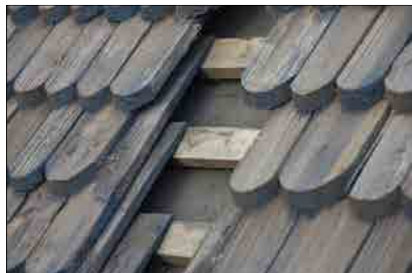
Figur 3.68. Demonterade spån blottlägger underliggande läkt och papp. Foto Jennie Björklund.
