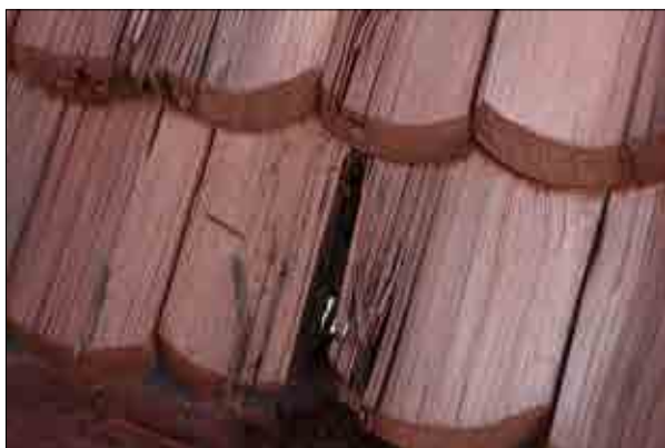
Figur 3.22. Närbild på rötskadade spån på södra takfallet. Foto Jennie Björklund.
