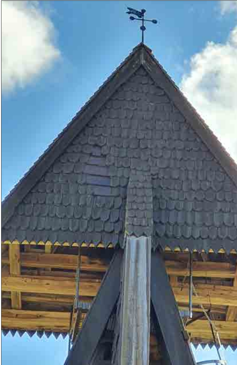
Figur 3.151. Klockstapelns norra fasad med tillfällig intäckning efter demontering av spån. Foto Lisa Skanser.
