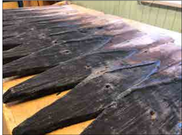
Figur 3.279. Några av sakristians spån i verkstaden under hantverksanalys. Här syns hur spånen har eroderat. Foto Daniel Eriksson.
