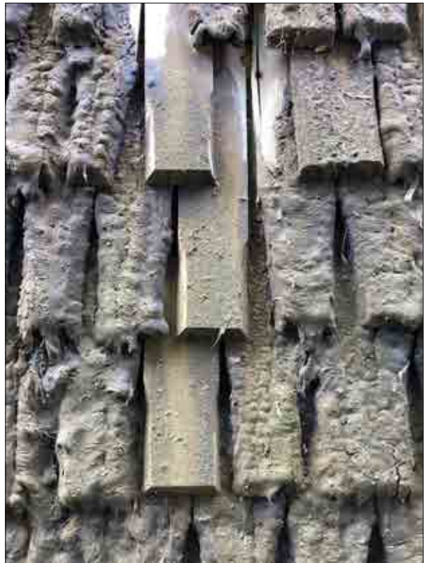
Figur 3.214. Bilden visar en tidigare reparation. Foto Daniel Eriksson.
