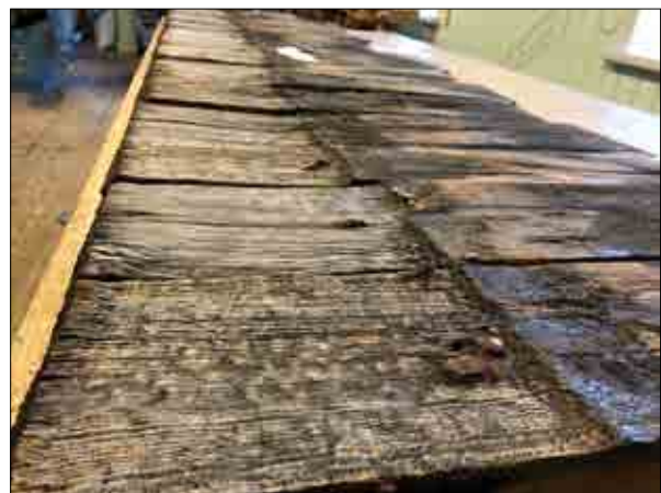
Figur 3.78. Demonterade spån i verkstad. Ovansidorna uppvisar tydlig erosion. Foto Daniel Eriksson.
