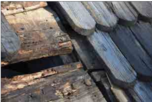
Figur 3.287. Närbild på skador i undertaket som blottades efter demonteringen av spån. Foto Jennie Björklund.
