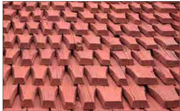
Figur 3.48. Detalj av spåntäckningen på södra takfallet, där spånen har stor förekomst av sprickor. Foto Sanna Svensson.
