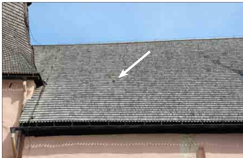
Figur 3.147. Återmonterade spån på långhusets södra takfall markerade med pil. Det nytillverkade spånet syns som en svart punkt. Foto Lisa Skanser.
