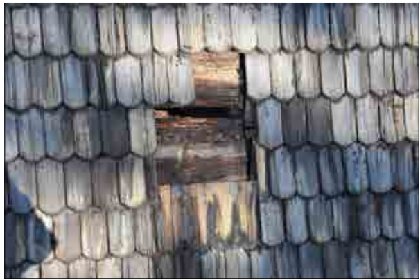
Figur 3.286. Efter demontering av spån. Undertaket är skadat. Foto Jennie Björklund.
