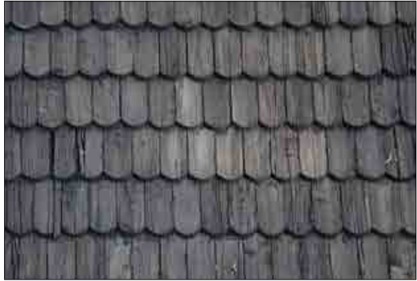
Figur 3.285. Del av långhusets södra takfall. Spånen uppvisar en del skador. Foto Jennie Björklund.
