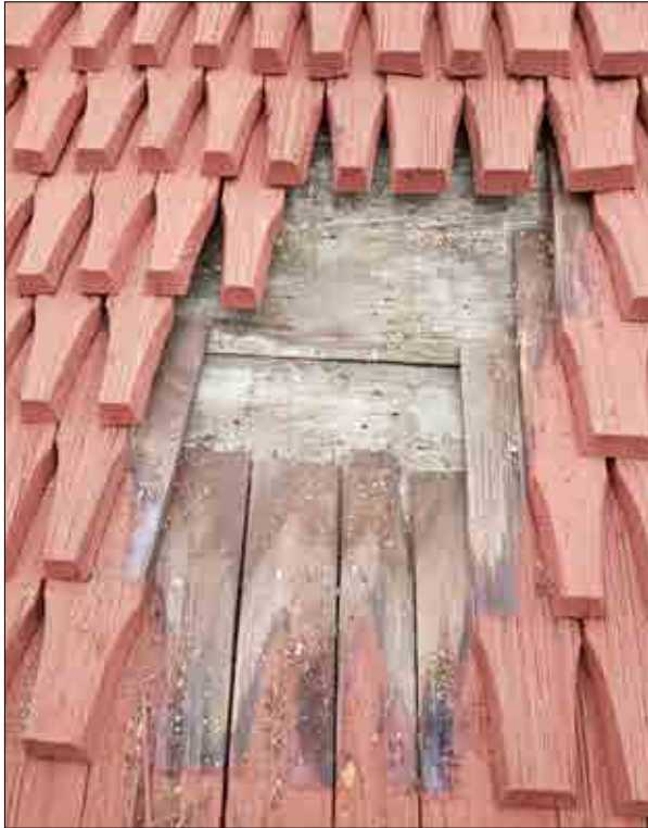
Figur 3.47. Undertaket efter demontering av spån. Troligen finns tre generationers spånbål. Foto Sanna Svensson.
