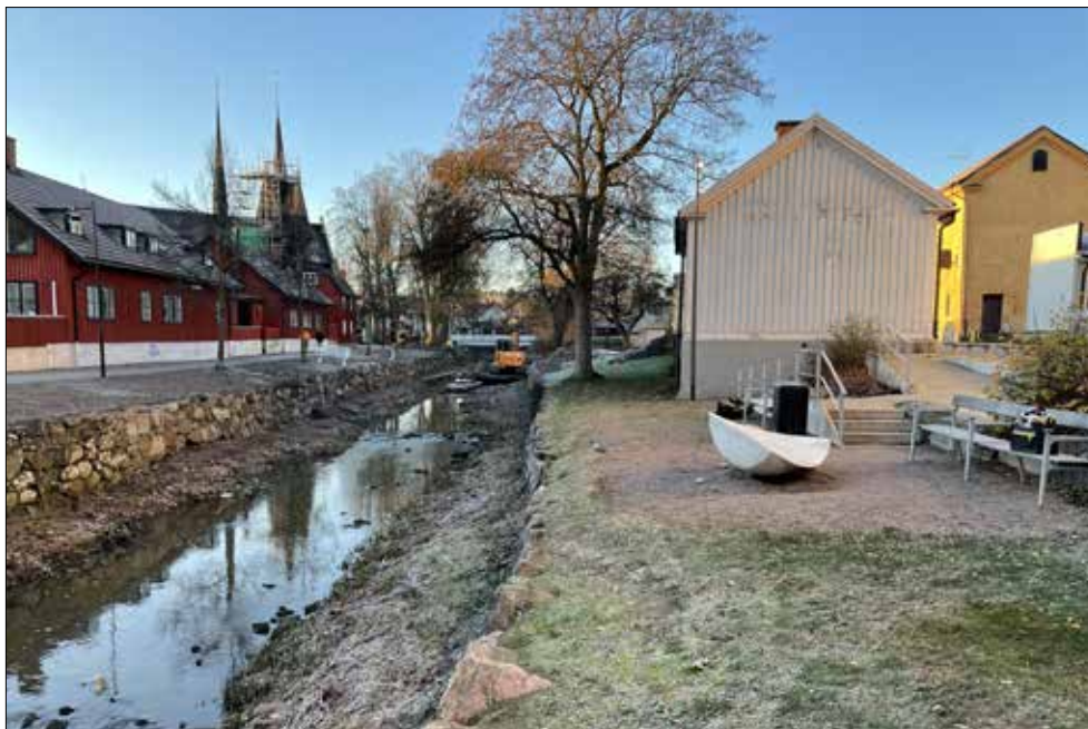
Figur 3. Undersökningsområdet från nordöst innan schaktningen började. Schaktet grävdes mellan den vita skulpturen och skoningsmuren till ån.
