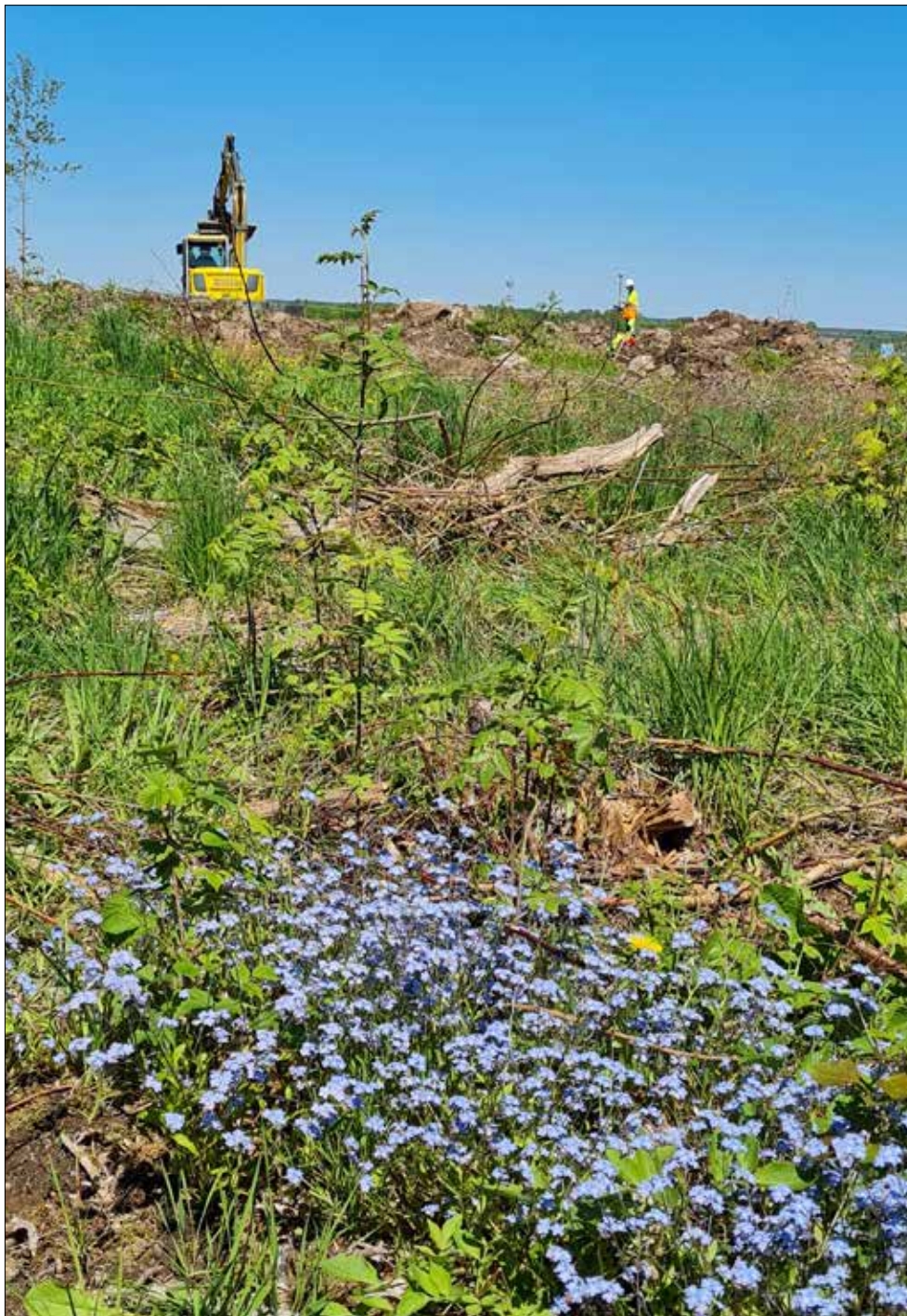
Figur 13. L2021:276 sett från L2021:275 i söder. Grävmaskinen har börjat lägga igen ett av schakten, medan anläggningar och stenblock mäts in i ett annat. Foto Jenny Holm.
