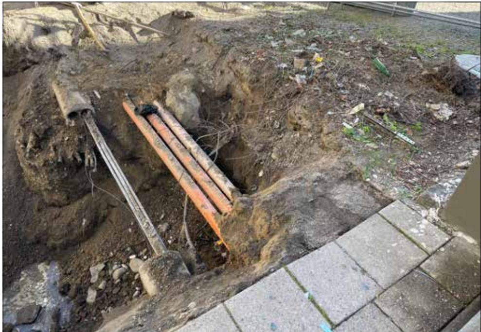
Figur 8. Östra delen av schaktet från söder. Bredvid elledningarna syns en sten i stenkonstruktion 1.
