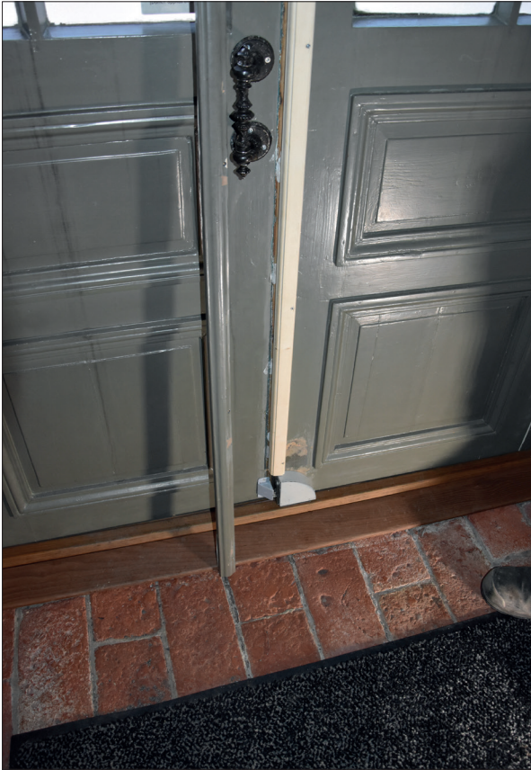
Figur 42. Slutbesiktning i december 2022. Dörrlisten skall återmonteras.
