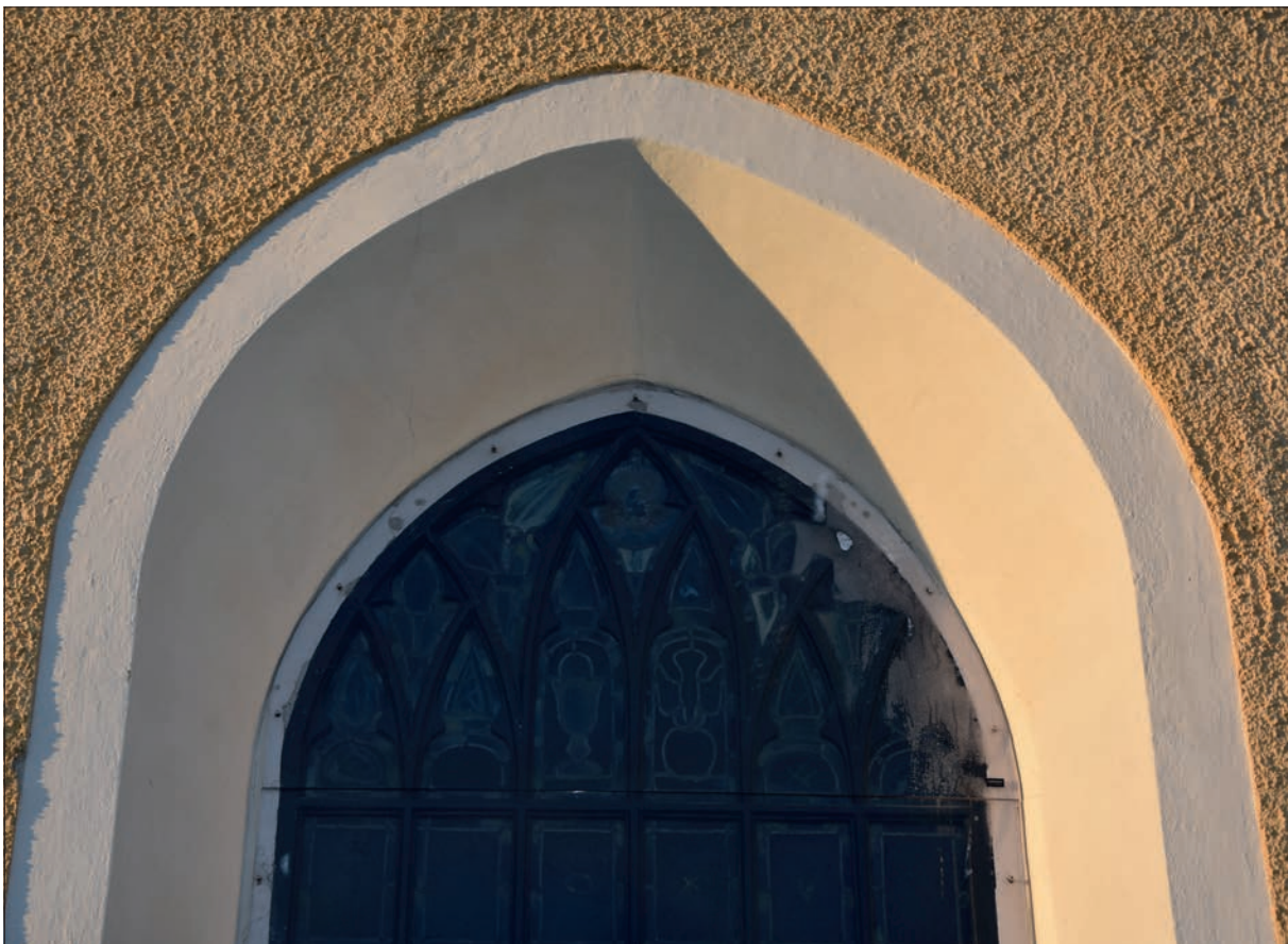
Figur 48. Det nya skyddsglasat består av två delar. Detalj av den övre rutan.
