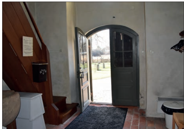
Figur 13. Entrédörren som enligt beslut skall vändas utåt.
