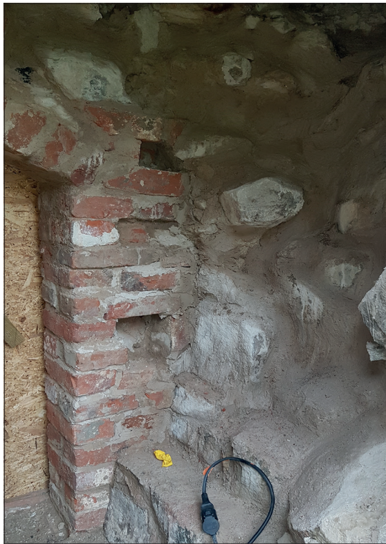
Figur 20. Efter att gråstensmuren åter satts tillbaka med kalkstensbruk och tegelmuren runt öppningen murats upp igen, med befintligt tegel.
