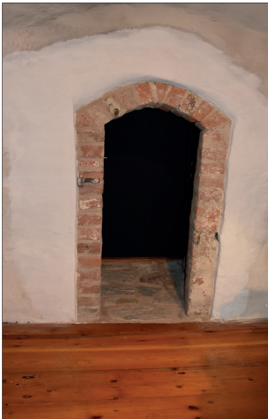
Figur 27. Besök i oktober 2020. Väggen är åter putsad och valvbågen fri från äldre puts. Ny puts avviker i kulör.
