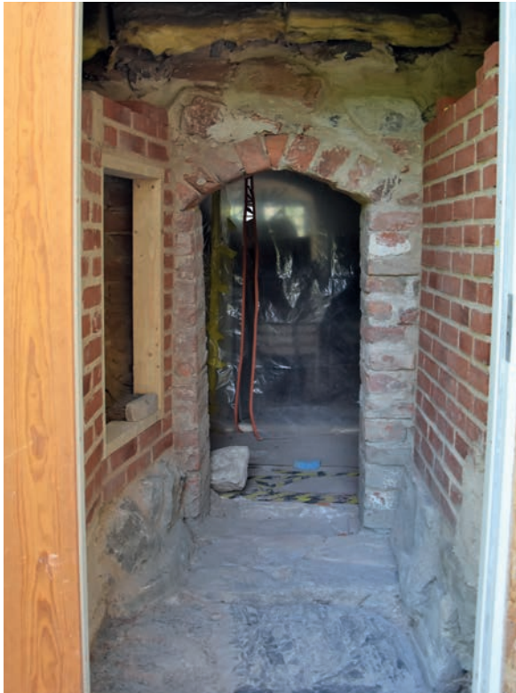
Figur 22. Besök i angusti. Nya tegelmurar på plats i passagen mellan yttermur och sakristian.
