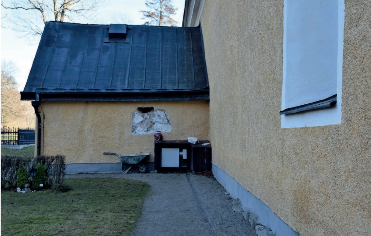
Figur 7. Vid nedknackning av sakristians puts, visar det sig att det inte finns spår av någon igenputsad dörröppning. Däremot finns ett hålrum mellan yttre och inre gråstensmuren.
