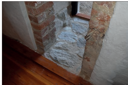
Figur 28. Golvet i sakristians möte med passagen. Lägg också märke till äldre bake som sparats.
