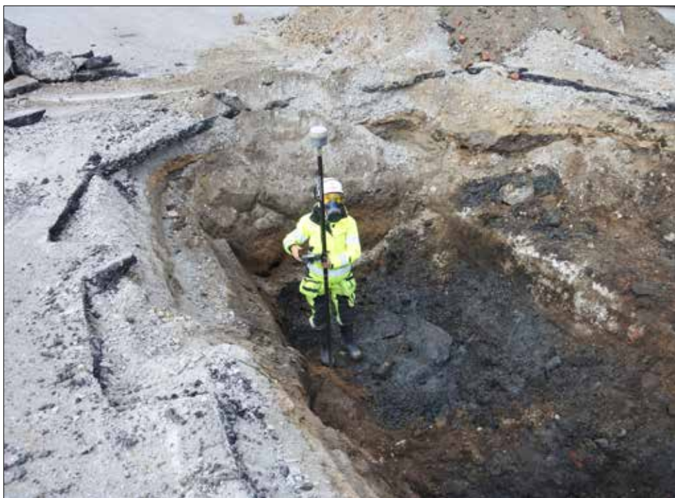
Figur 32. Sigourney Navarro mäter in stenkonstruktion 1457 i botten på schakt 10. Foto från sydöst.
