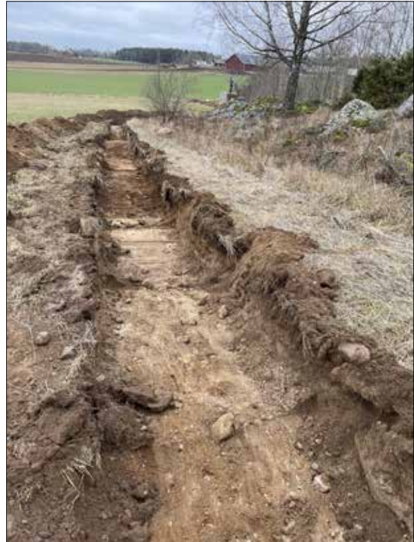
Figur 23. Översikt över den östra delen av schakt 215 i område 4. Foto Fredric Wirbrand från öster.
