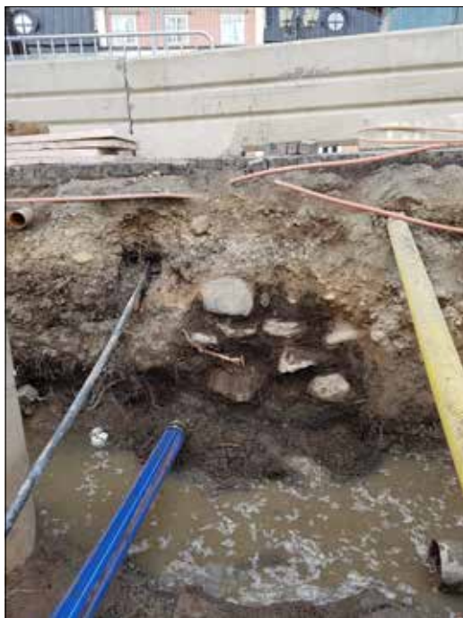
Figur 43. I schaktväggen framkom byggelse lämningar i form av syllstenar till hus 10 och 11. I schaktets botten ses vatten från ledningar som byttes. Foto från öster.
