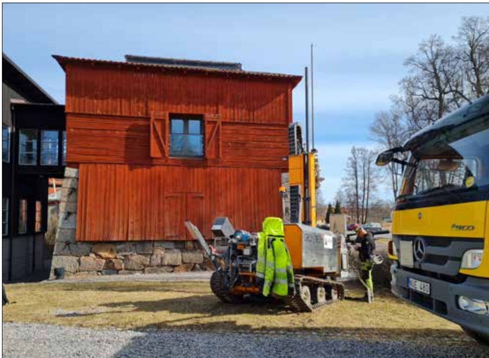
Figur 6. Pågående borrning vid punkt SM4. Arkivet är sedan 2011 inhyst i den röda nykonstruerade (1997) träöverbyggnaden som står på den bevarade stenfoten efter masugnen från 1795. Masugnsfoten utgör fornlämning L1983:7846.
