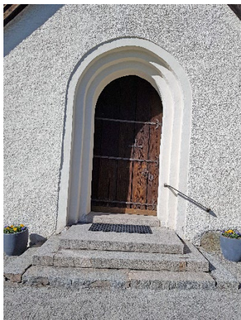
Figur 60. Södra vapenhuset, dörr före åtgärder
