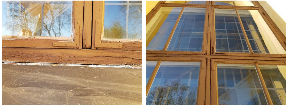
Figur 5. Södra fasaden västra delen uttorkat samt glipa mellan mittpost och karmbotten.
