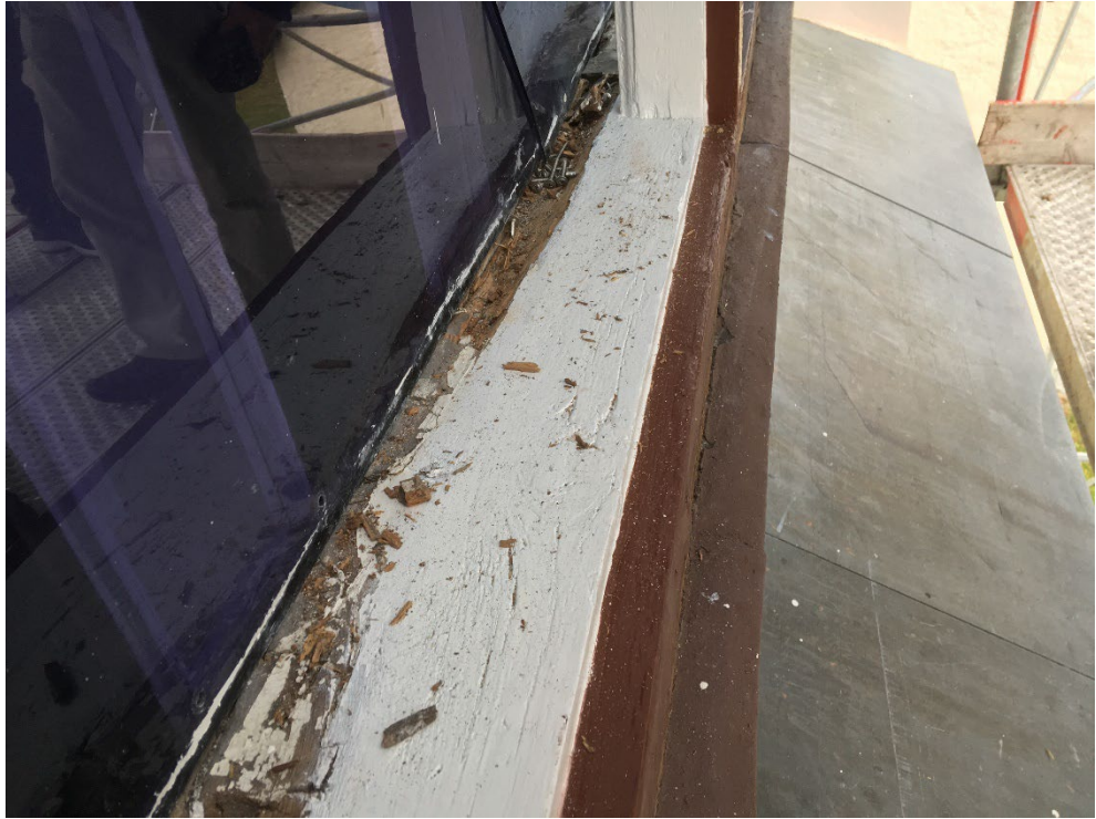
Figur 65. Omfattande rötskador i karmbottenstycke korffönster, sett mot norr.
