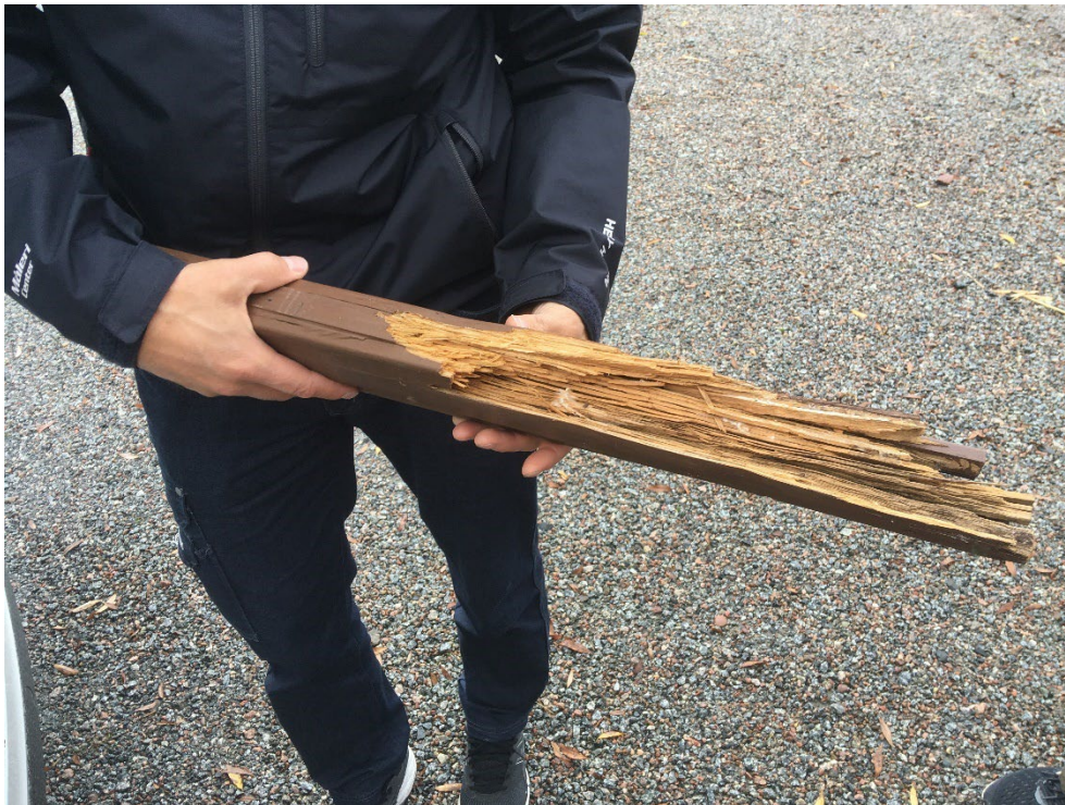
Figur 13. Fönsterposten i västra lanterninfönstret var mycket rötskadad och såväl mittpost som byttes.
