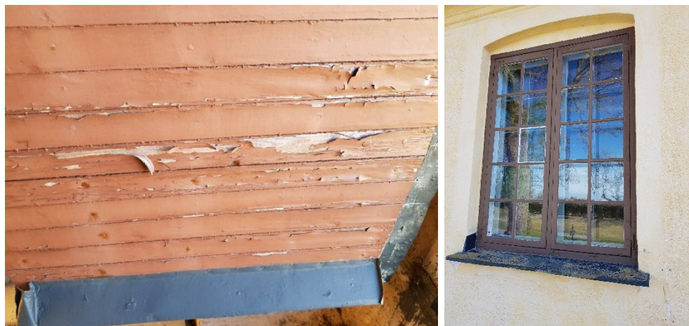
Figur 9. Exempel på färgbortfall från en av ljudluckorna. Stora slagande partier.
