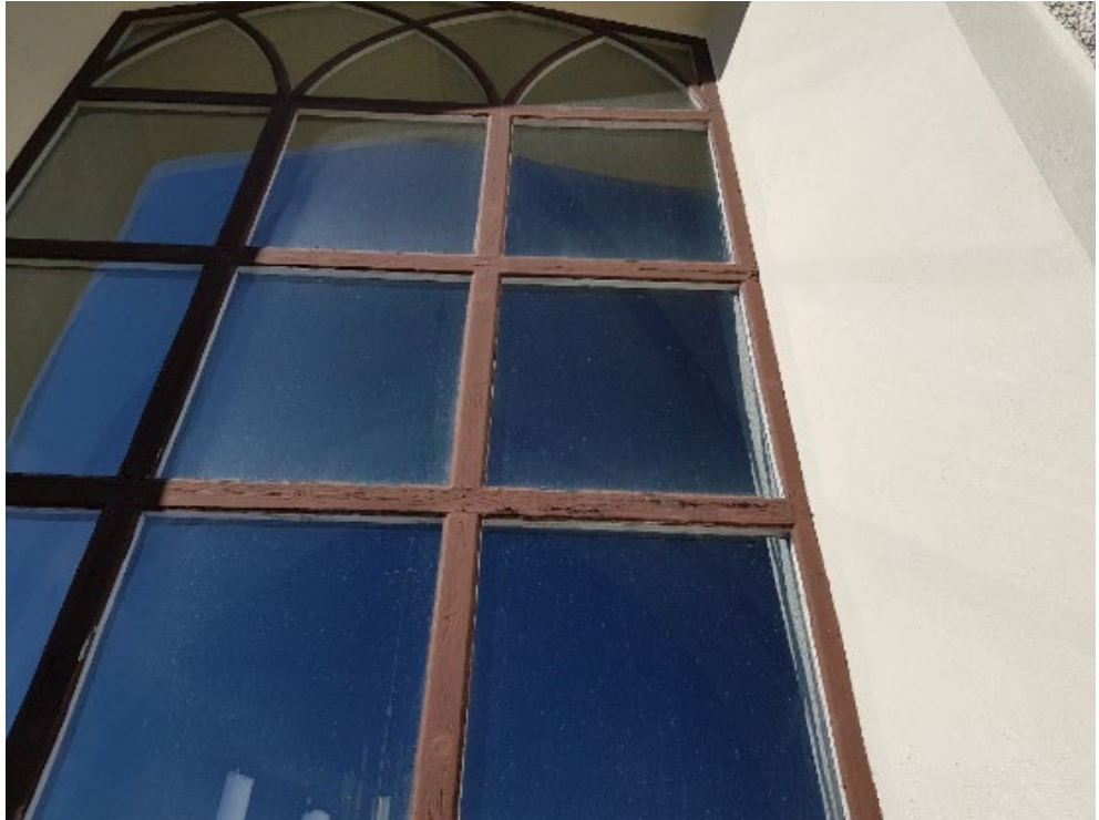
Figur 59. Sprickor i träet på fönsterbåge i söder.
