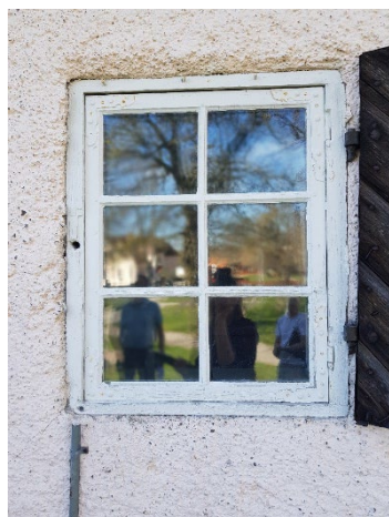
Figur 37. Sakristians fönster före åtgärder.
