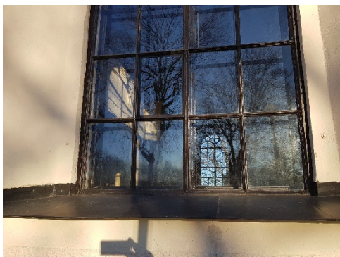
Figur 42. Båge efter åtgärder.
