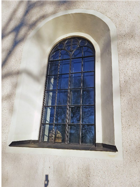
Figur 44. Båge efter åtgärder.
