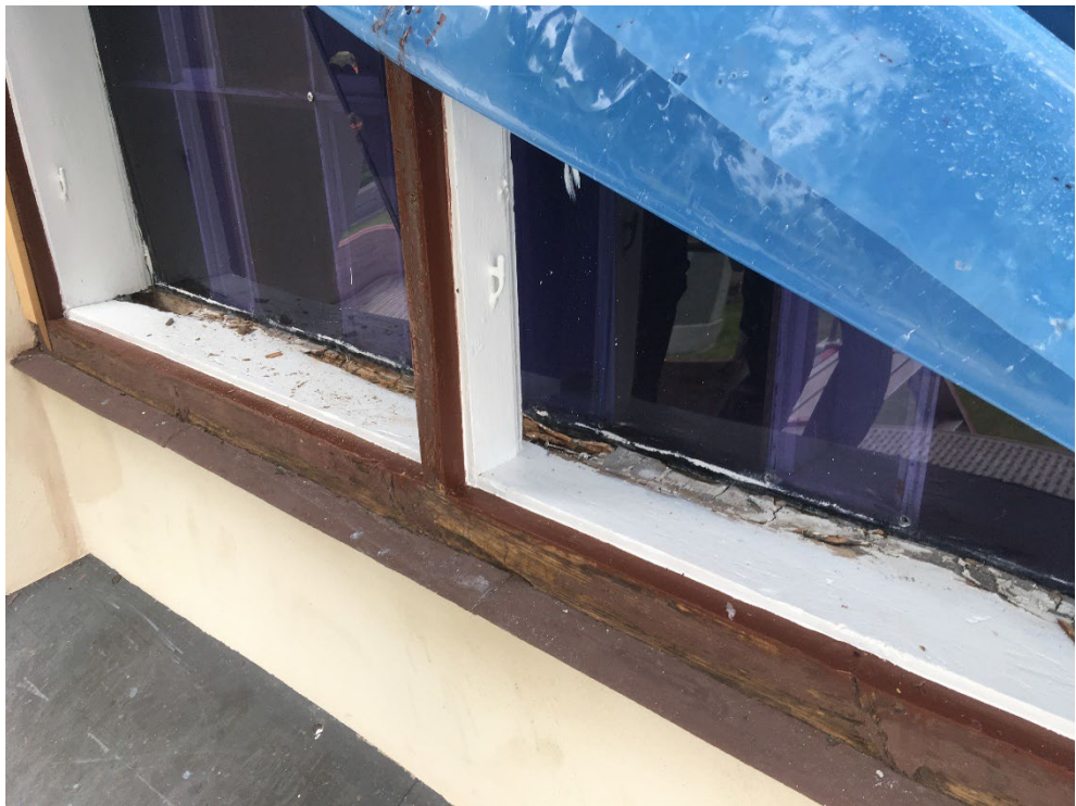
Figur 66. Omfattande rötskador i korffönstrets karmbottenstycke sett mot sydväst.
