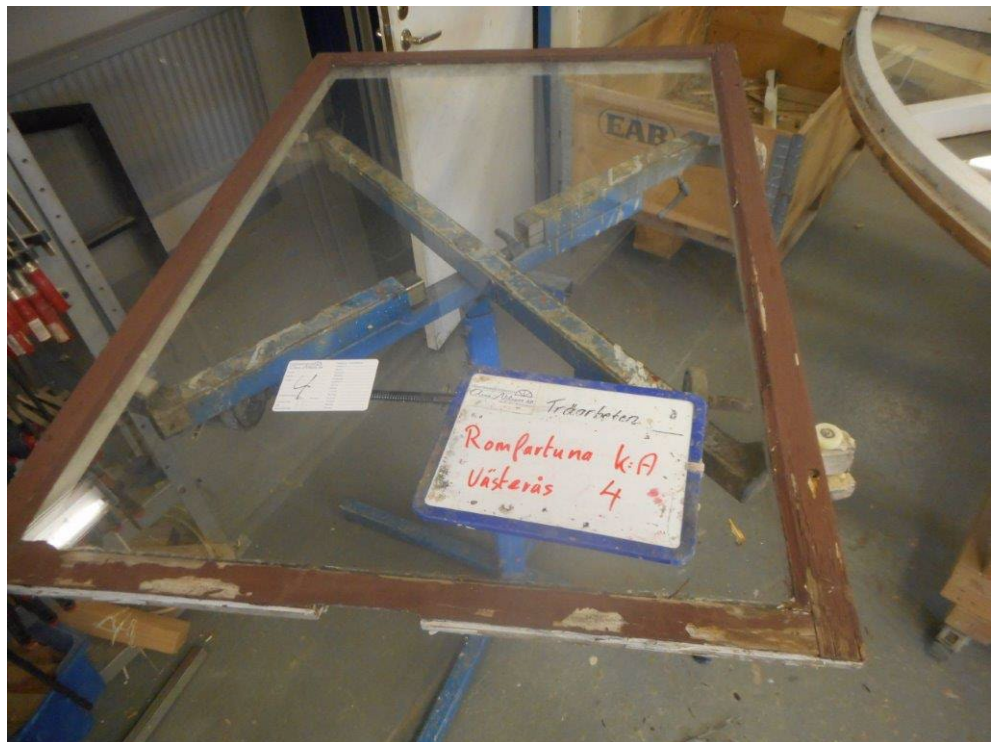
Figur 71. Skador fönsterbåge från Romfartuna.
