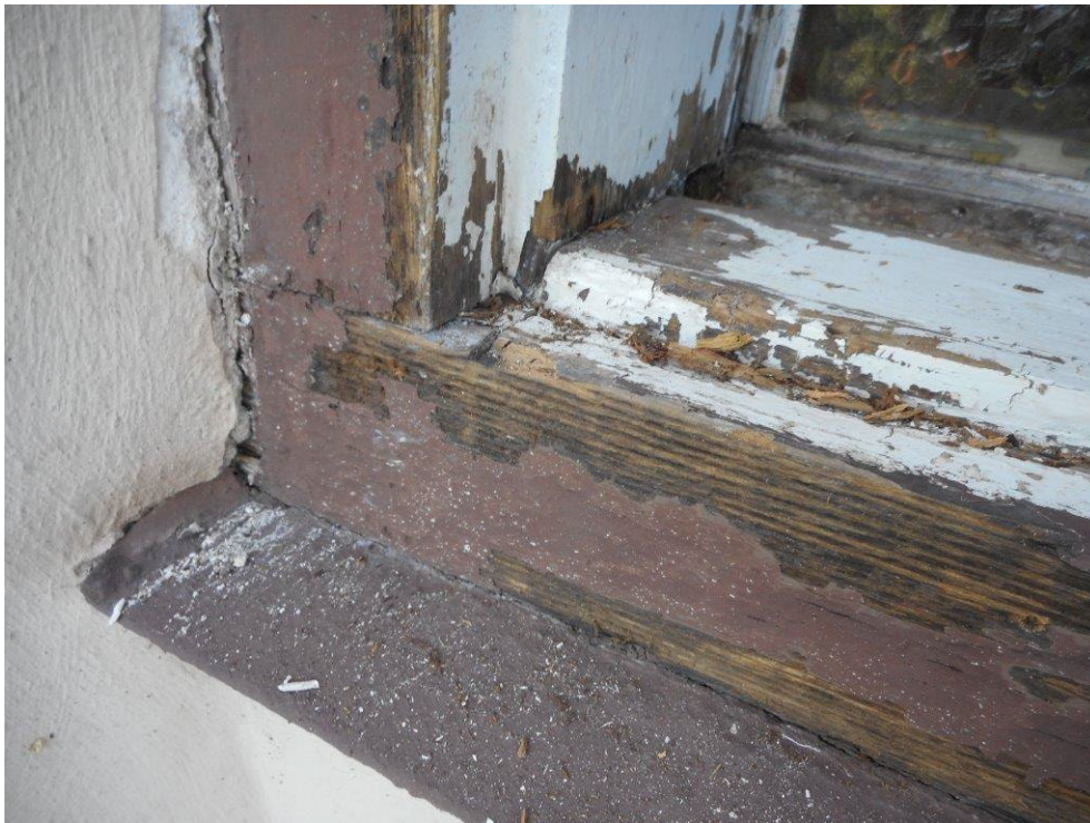
Figur 64. Skador i karmens nedre södra del.
