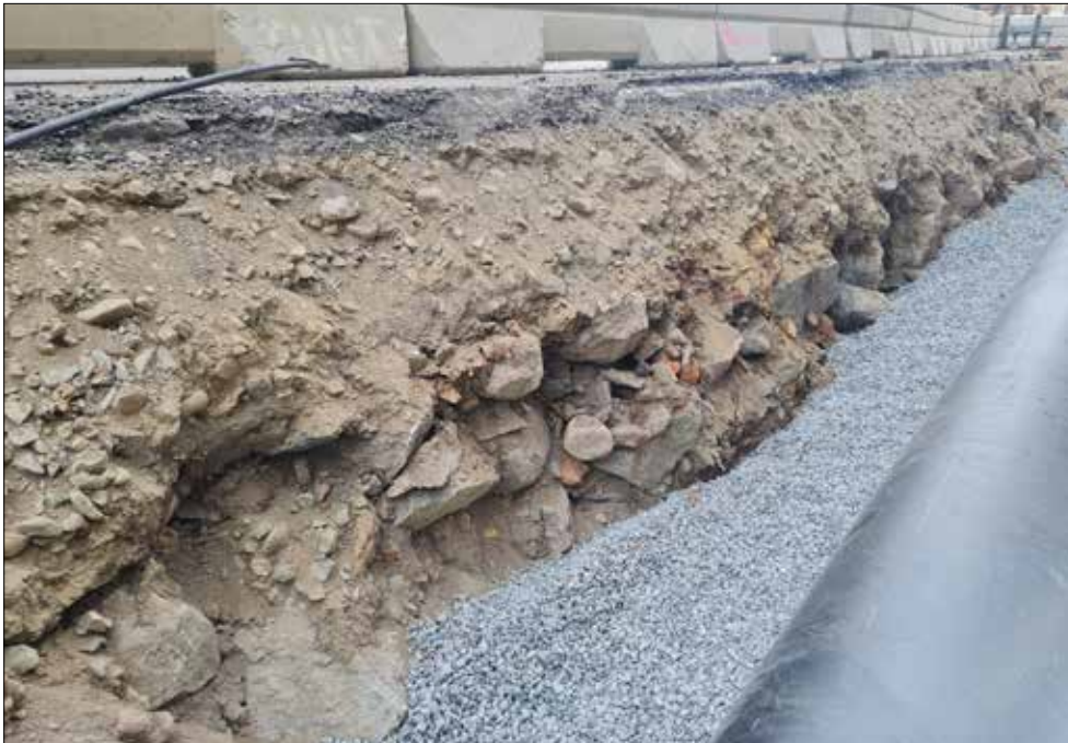
Figur 46. Del av södra schaktväggen i schakt 2 där den gick genom Mungatan. Den stora mängden stenar har sannolikt ett samband med omläggningen av Lillån kring sekelskiftet 1900. Foto från öster.
