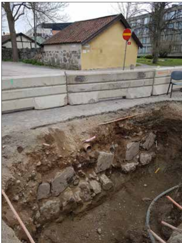
Figur 55. Del av den västra delen av kyrkogårdsmuren A326. Notera stenpartiet i norra väggen på huset "Sotarns stuga" i bakgrunden. Där har kyrkogårdsmuren byggts in i husets vägg och muren fortätter österut. Foto från nordväst av Jonas Ros.
