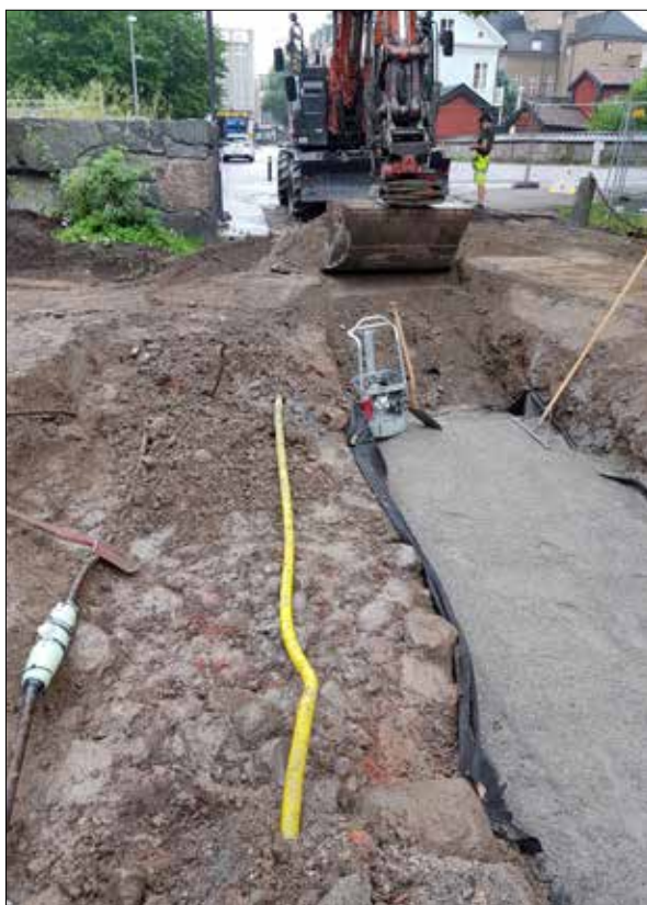
Figur 47. Den stenlagda ytan A40 som var blöt av regn. På gatan ses två elkablar. Till höger ses schaktet som hade börjat fyllas med grus på vilket matarledningarna till markvärmen lades. Foto från nordväst.
