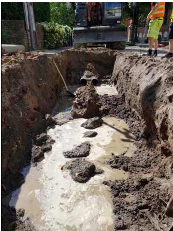
Figur 30. Syllstensrader till hus 4, A27, till höger och A28 till hus 5 till vänster, då de gamla matarledningarna tagits bort. Foto från nordväst.
