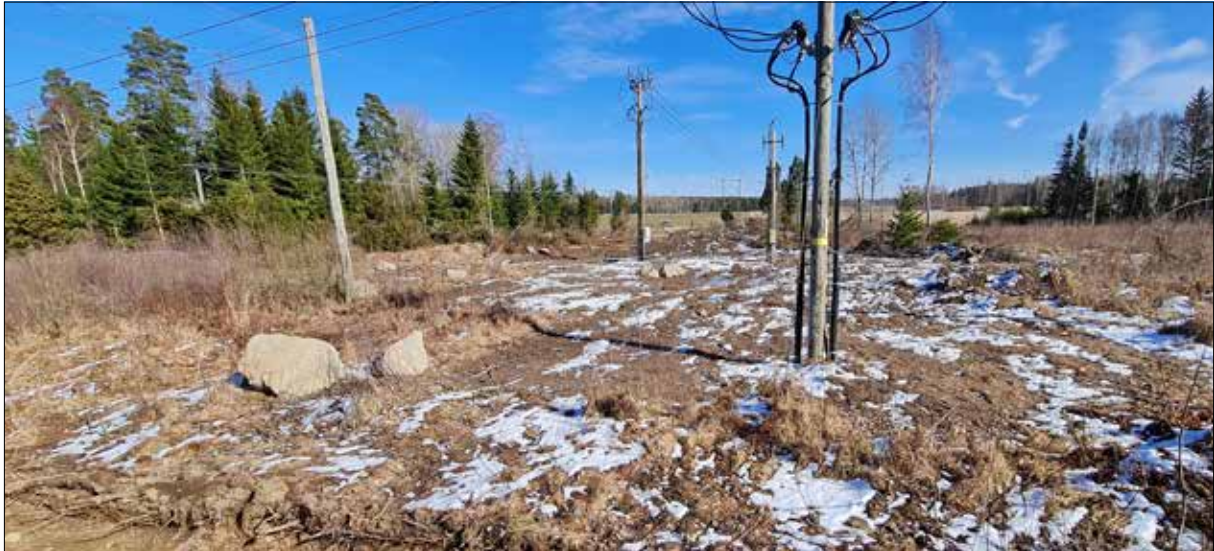
Figur 3. Det schaktskadade området vid torplämningen. I nedre vänstra hörnet syns sydöstra delen av schakt S15. Foto från väster.
