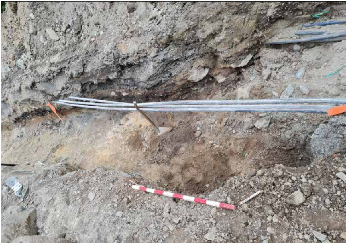
Figur 22. Kabelstammar nedgrävda genom bytomten. I botten påträffades spår av kulturlager och sten. Foto från nordväst.
